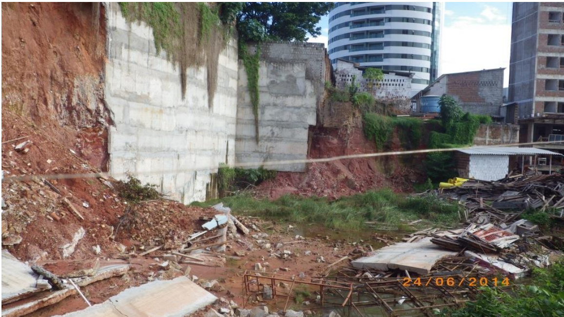
Infiltrações na base da cortina, evidenciando o talude saturado
