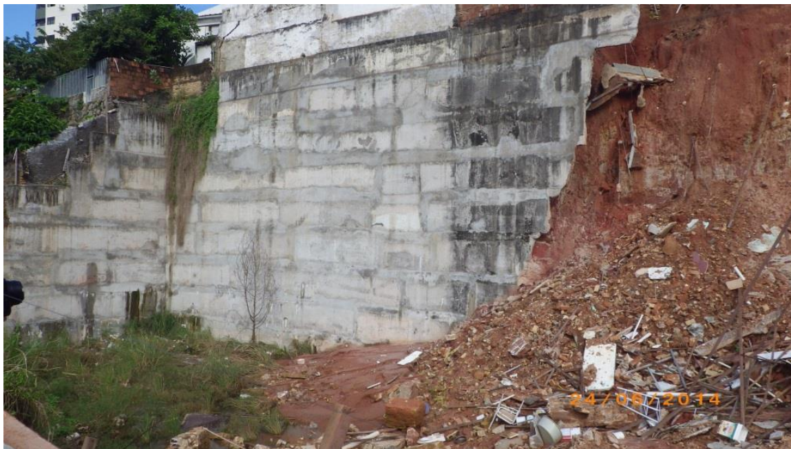
Mesma situação de infiltrações na base da cortina – talude saturado
