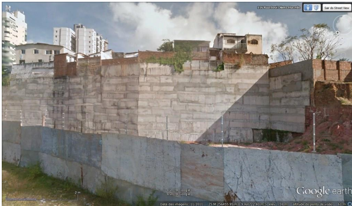
Situação pretérita (2011) – Observe-se as construções sobrepostas à cortina atirantada
