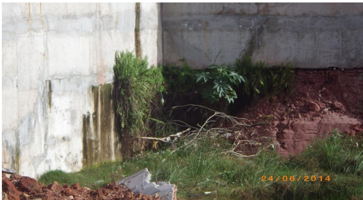
Detalhe da infiltração através de fissuras na cortina no lado direito – lodo e vegetação são indícios de água represada na cortina
