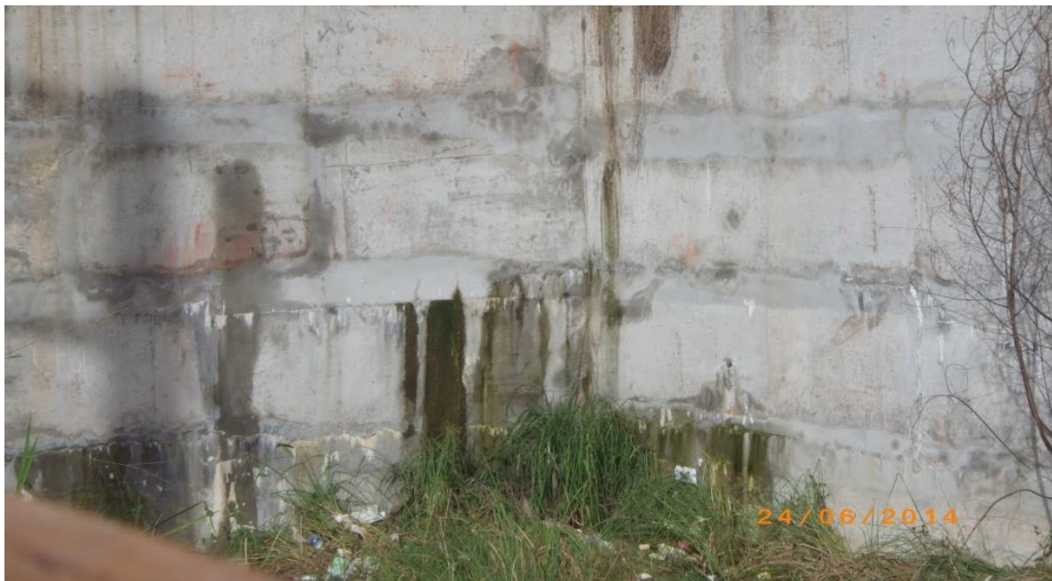
O problema se repete no lado esquerdo, evidenciando risco de futura ruptura.
