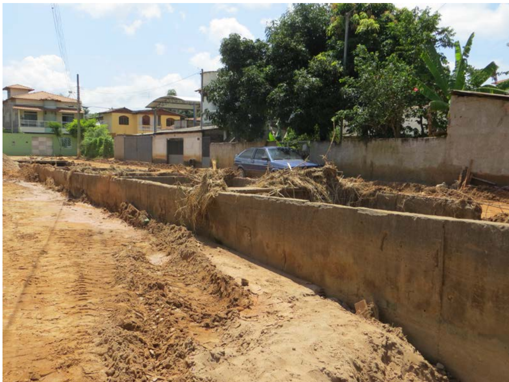
Imagem mostrando área atingida pela inundação
