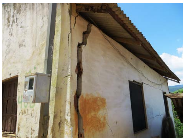
Imagem de rachaduras na paredes do imóvel
