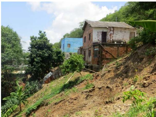
Imagem da encosta a jusante das rachaduras do terreno
