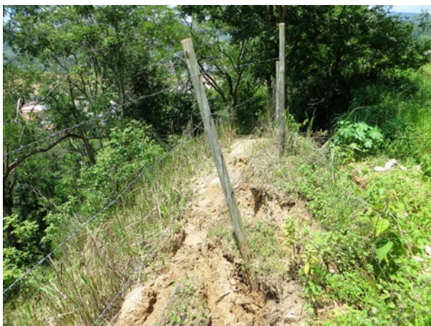
Imagem mostrando mourões inclinados e trincas no terreno
