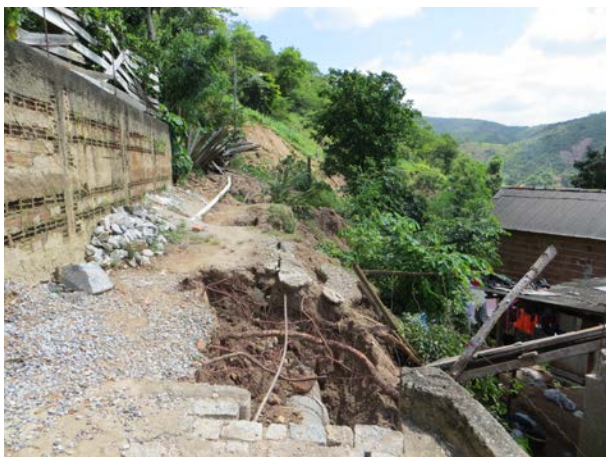
Imagem de rua parcialmente desmoronada
