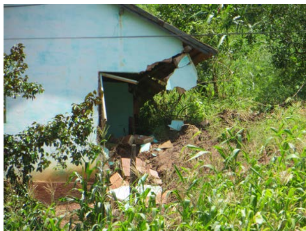
Imagem de casa parcialmente destruída por deslizamento
