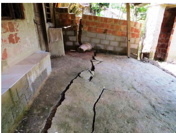
Imagem das trincas e rachaduras nos fundos do imóvel
