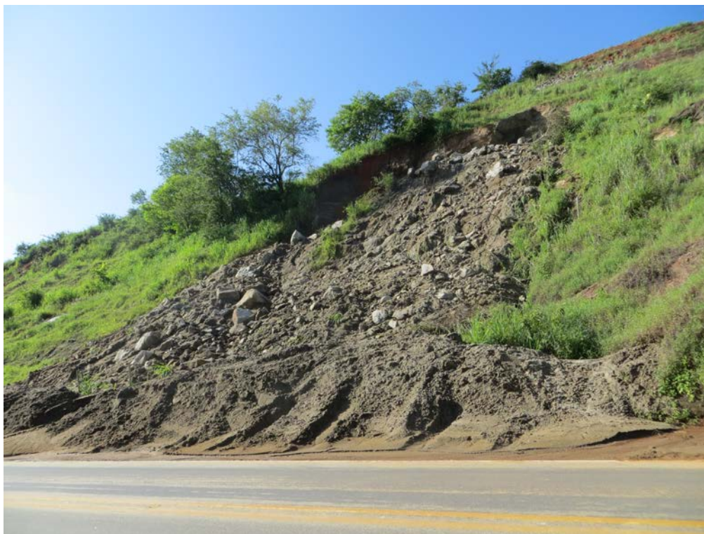
Imagem mostrando deslizamento de detritos em talude de rodovia
