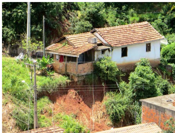
Imagem de casa parcialmente com fundações expostas por deslizamento
