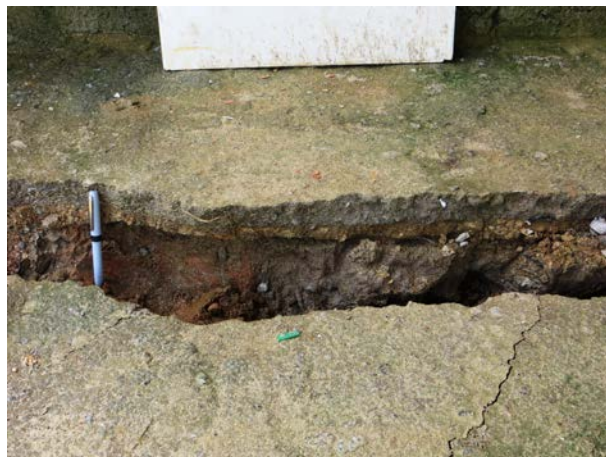
Imagem mostrando em detalhe a trinca com seu abatimento
