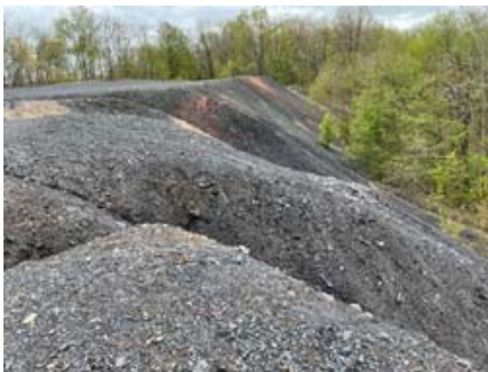
Figura 7B. Pilha de rejeito com feições de combustão espontânea (manchas avermelhadas).
