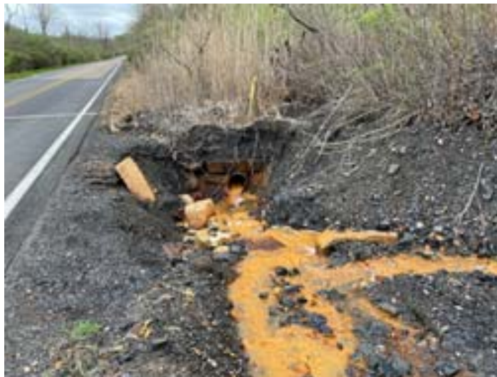
Figura 4B. Rejeito de carvão com geração de DAM ao lado de rodovia.
