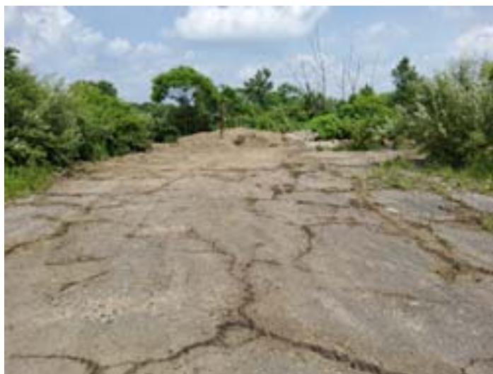
Figura 15A. Local da subsidência de mina.
