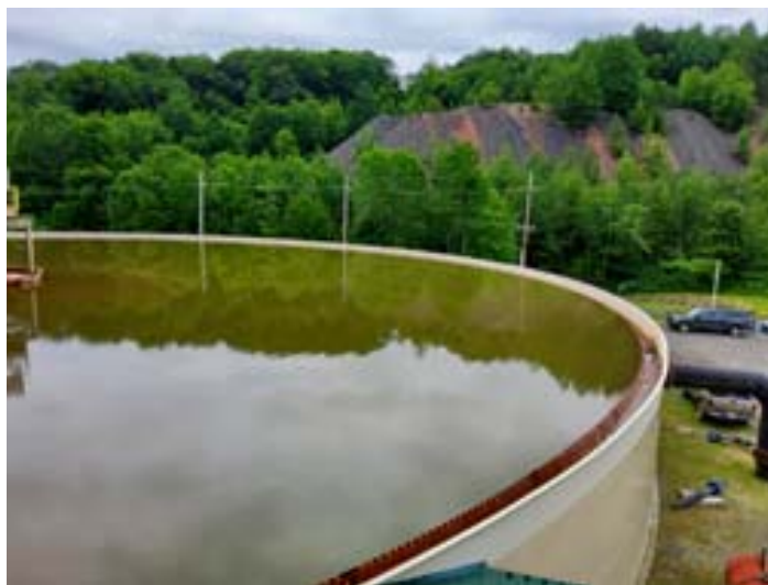
Figura 13B. Tanque de sedimentação para precipitação de metais pelo processo de oxidação e neutralização.
