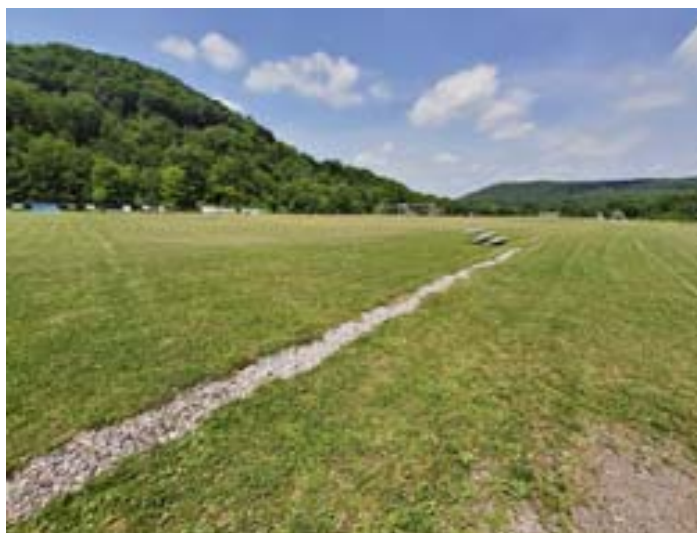
Figura 14D. Área após a recuperação, com utilização para atividades de esporte e lazer.
