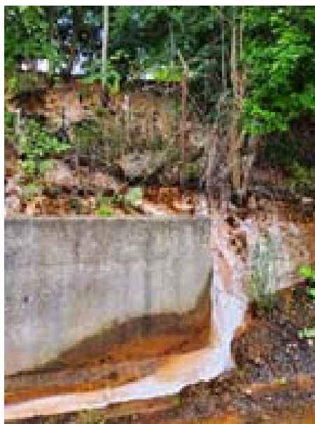
Figura 10A. Surgência de DAM em área urbana.
