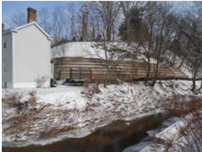
Figura 8D. Muro de contenção com efeitos de congelamento do solo, que causam problemas estruturais.
