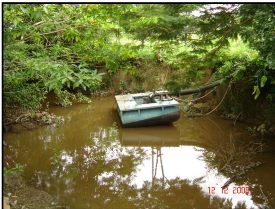
Foto 1. Captação de água superficial pela CAERD. Igarapé Pregão.
