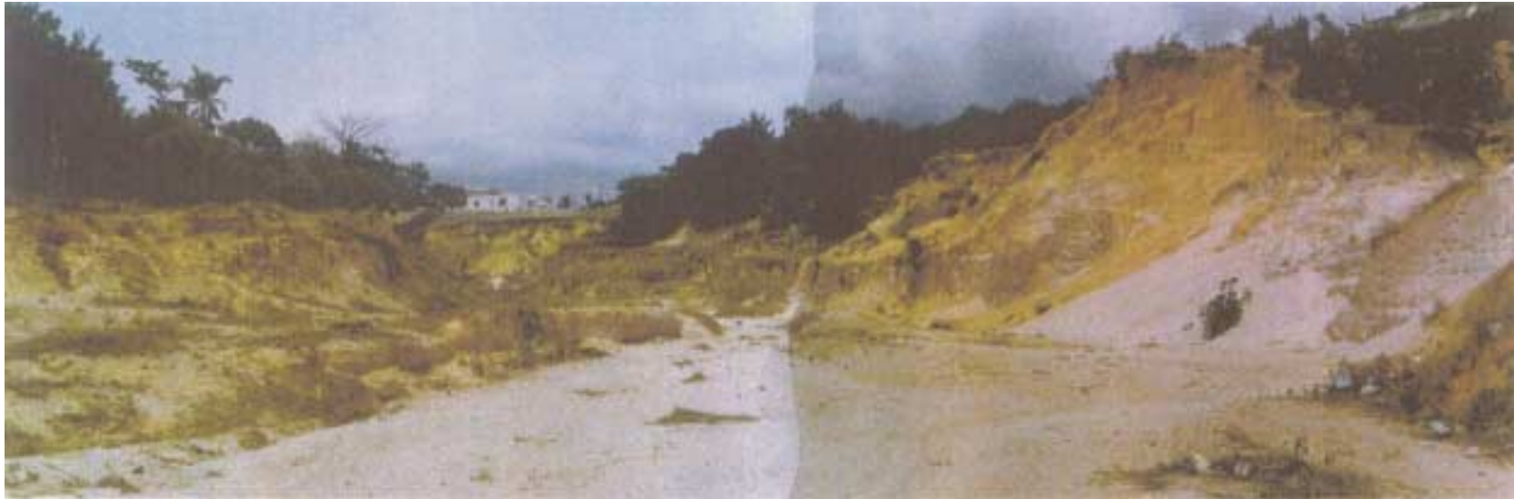
Foto 03 - Vista parcial da Voçoroca de Curaxi de jusante para montante. Em primeiro plano, o leito arenoso e plano. Ao fundo, a cabeceira da voçoroca com a obra arruinada.
