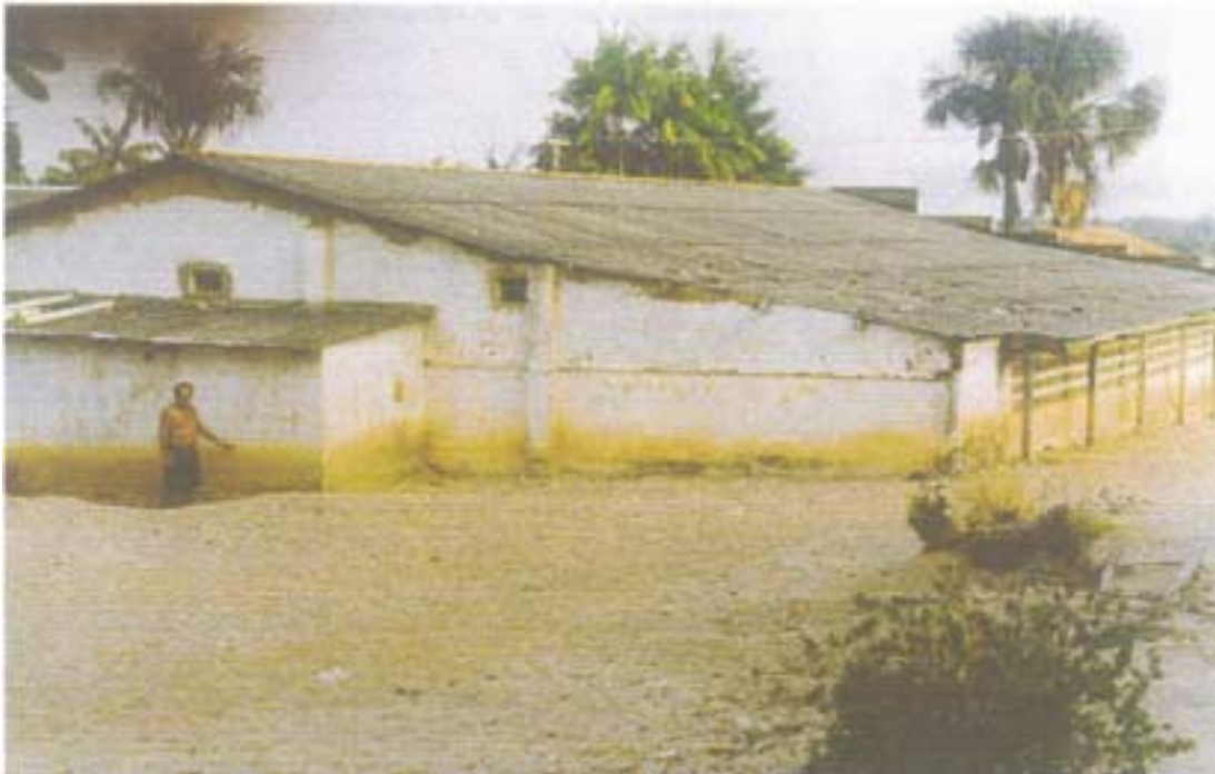
Foto 17 – Construção (sede Social dos Pescadores) parcialmente soterrada pelo assoreamento à jusante da voçoroca de Camarazinho. O Sr. Vladimir mostra a marca das águas de chuva (marca de cheia).
