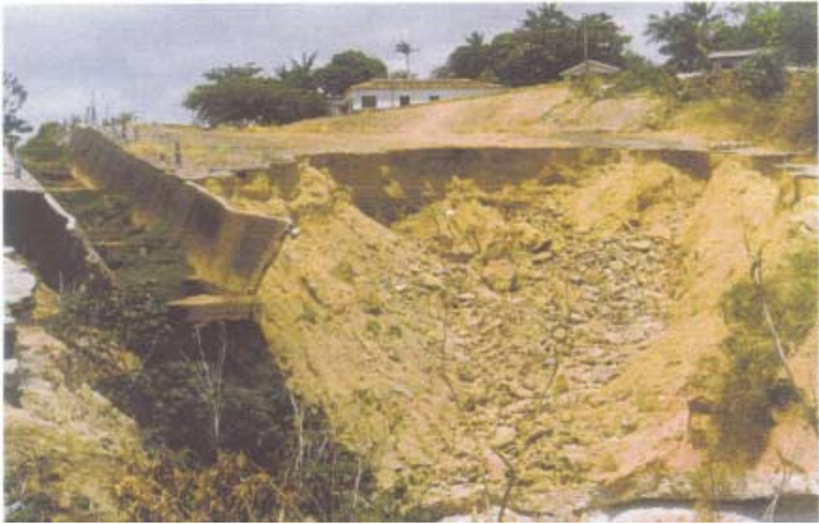
Foto 04 - Cabeceira da voçoroca de Curaxi (Covão do Curaxi). A erosão remontante provocada por águas pluviais arruinou totalmente a obra, colocando em risco as construções próximas.
