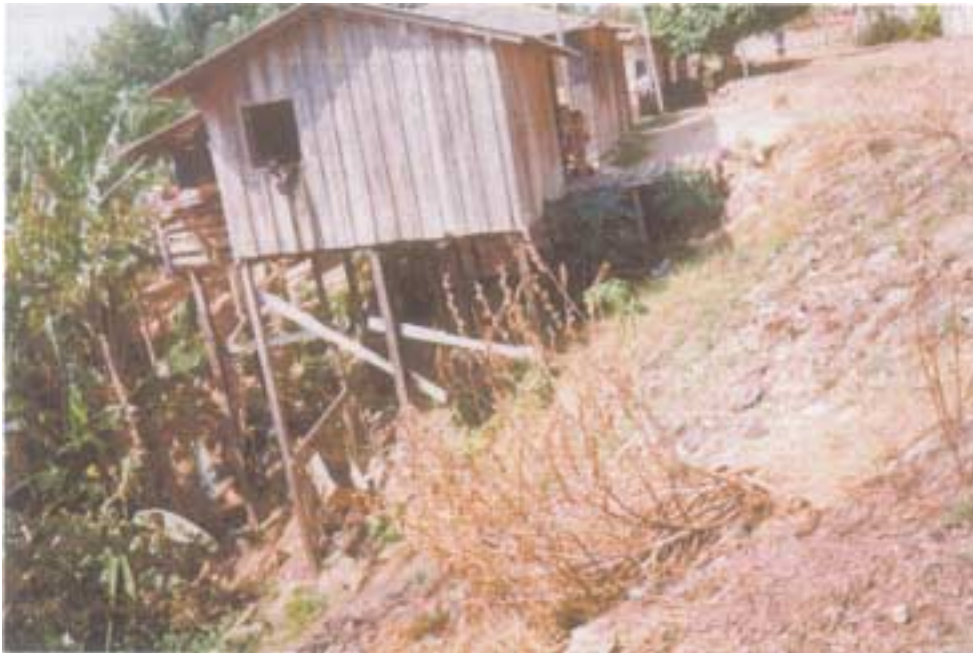
Foto 01 - Vista parcial do segundo braço esquerdo da voçoroca do Curaxi, mostrando a adaptação dos barrancos à erosão e a rua Ivo Cruz sendo erodida.
