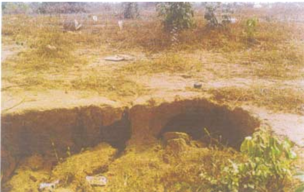
Foto 21 – Aspecto da erosão remontante na área da cabeceira da ravina da COMARA. Ao fundo a cerca da pista do aeroporto de Monte Alegre.
