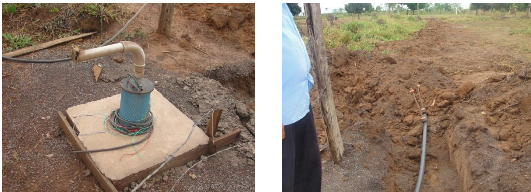
Figura 8 - Poço com vazão de 7 m 3 /h, para abastecimento da comunidade (553581E, 8765397N).
