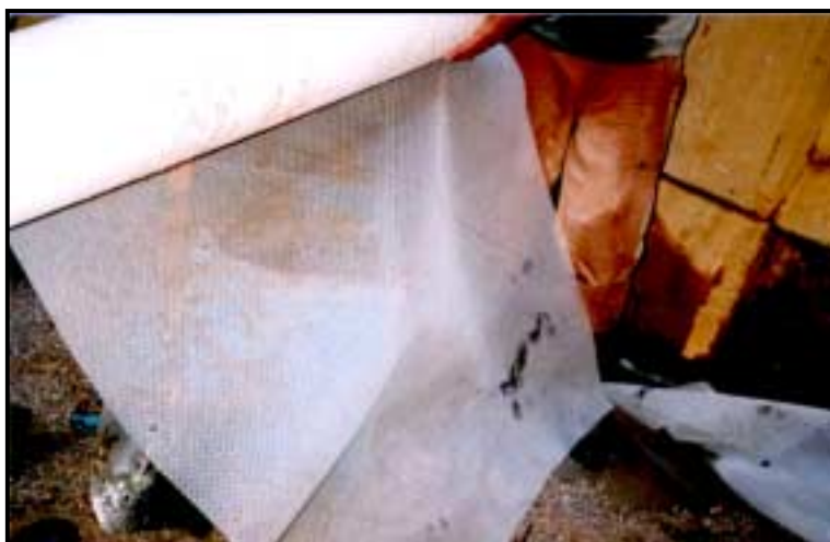
Foto 21 - Telas de nylon para retenção de sólidos para dentro do poço coletor
