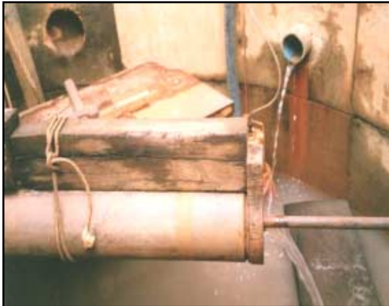
Foto 12 - Operação de retirada dos tubos de 6 5/8" com sistema de escoramento dos filtros por tubo de 1"
