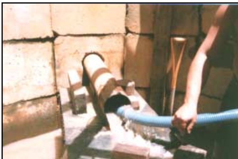
Foto 19 - Sistema de limpeza dos tubos por carreamento hidráulico
