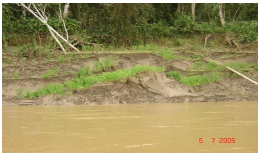
Figura 8: Escorregamento dos taludes fluviais por efeito da pressão hidrostática. Rio Madeira
