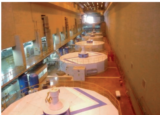
Figura 31 - Geradores de energia elétrica da Hidrelétrica de Balbina.
