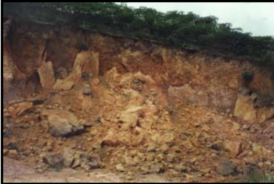
Foto 1 - Erosão em Talude Formado por Arenitos da Formação Cabo. Engenho dos Macacos - Ipojuca.
