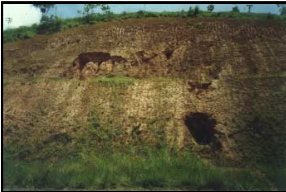
Foto 2 - Taludes com Alto Ângulo em Solo Residual de Gnaisse, Onde Notam-se Focos de Erosão. Estrada de Ligação Entre a Cidade de Ipojuca e a Rodovia BR-101.
