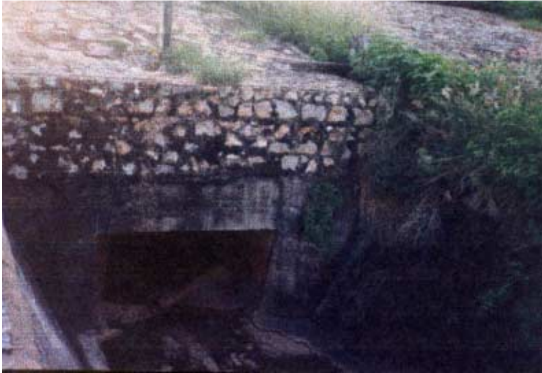
Foto 03 – Galeria de lançamento da água pluvial na Gruta Curaxi.
