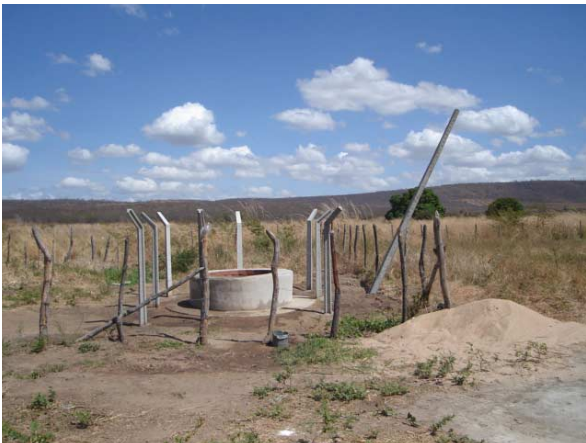
Foto 7.1 - Laje de proteção do aquífero/poço
