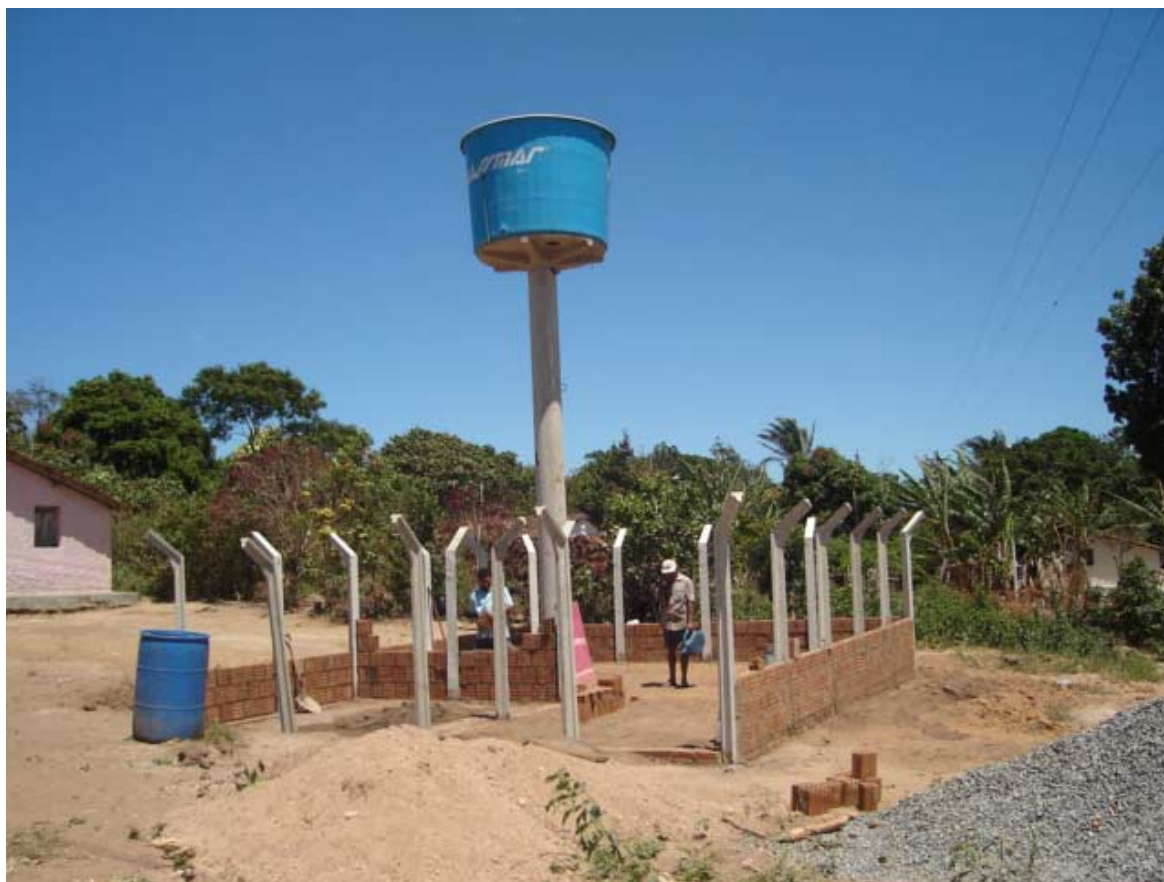
Foto 7.1 - Aspecto da construção da cerca de proteção e da caixa d'água elevada
