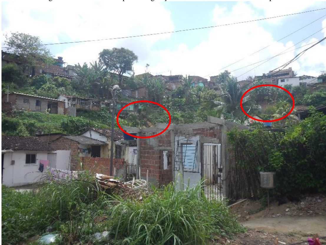
Figura 28 – Encosta com pouca vegetação. Em vermelho taludes com ruptura.
