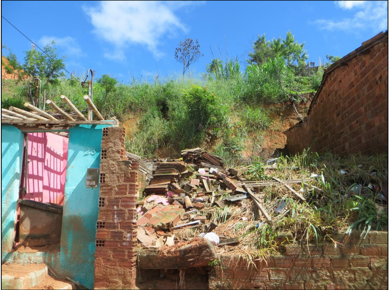
Foto 09: Registro de casa danificada por movimento de massa, devido às chuvas de 05/2017, antes da colocação das lonas plásticas, na Rua da Palha-Rua da Barreira.
