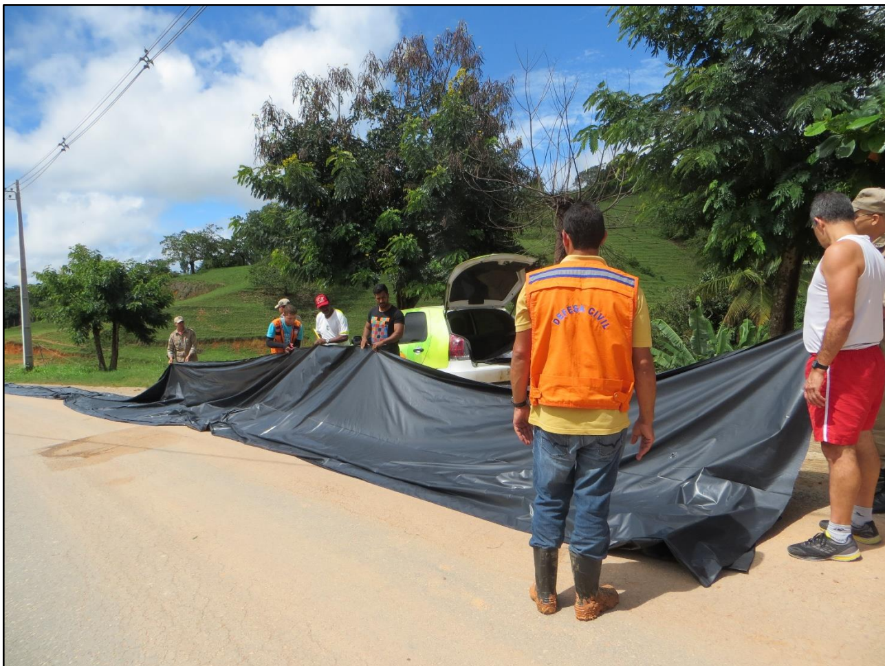
Foto 06: Lonas plásticas em processo de colocação pela Defesa Civil Municipal em parceria com os Bombeiros Militares da CODECIPE-Casa Militar do Estado de Pernambuco, para uso como proteção provisória, nas encostas da Rua da Palha-Rua da Barreira.
