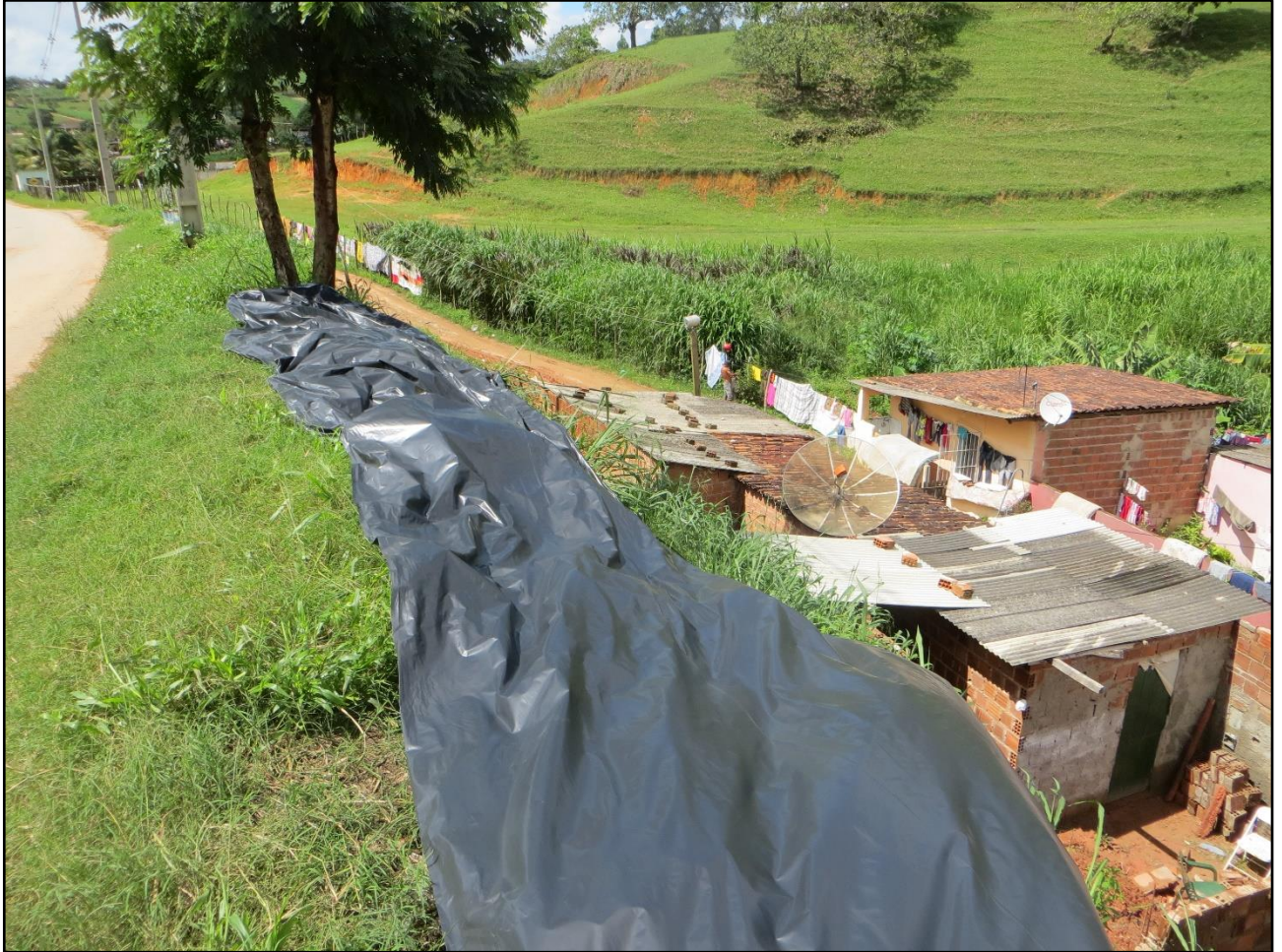
Foto 08: Lonas plásticas em processo de instalação e montagem pela Defesa Civil Municipal em parceria com os Bombeiros Militares da CODECIPE-Casa Militar do Estado de Pernambuco, para uso como proteção provisória, nas encostas da Rua da Palha - Rua da Barreira.
