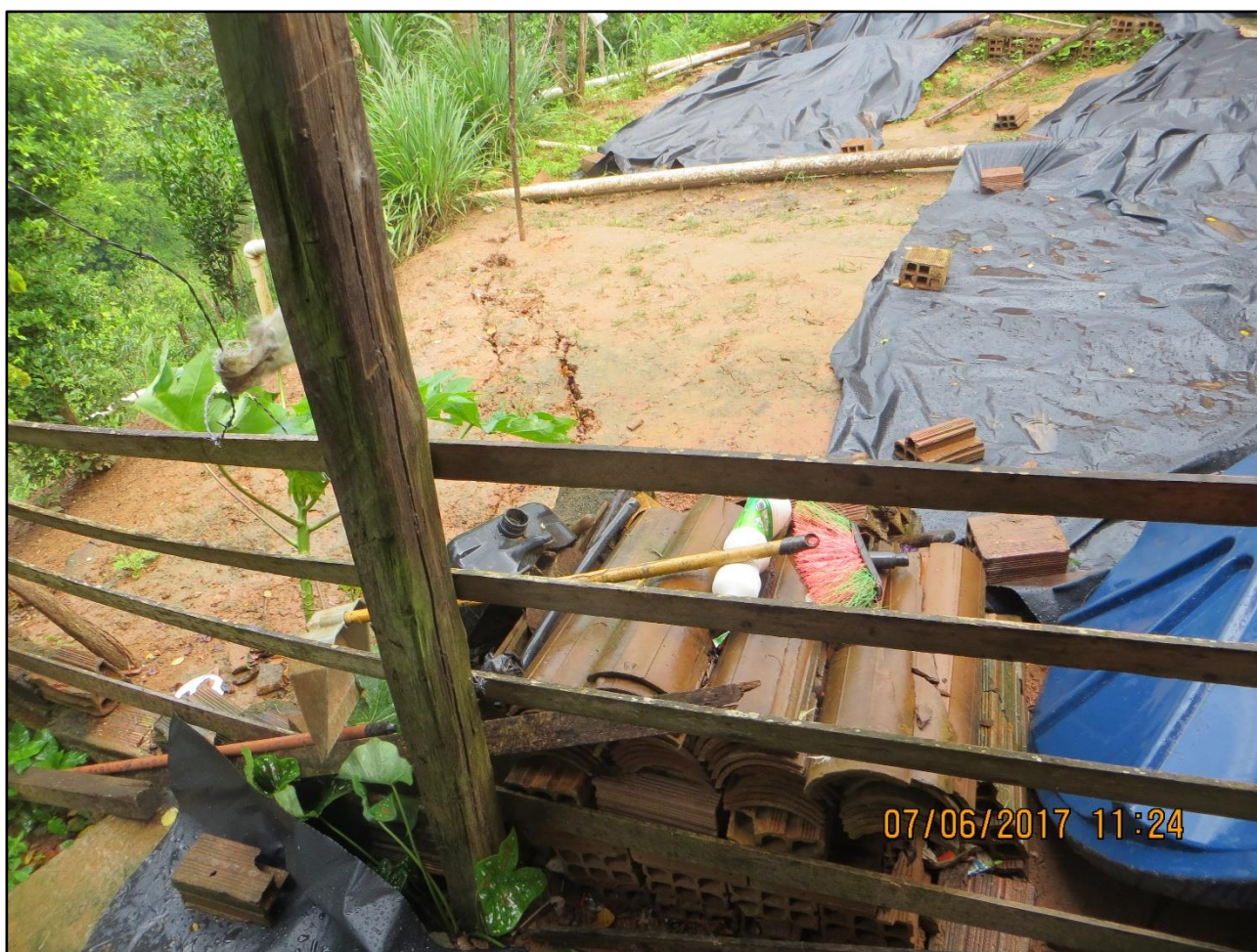
Foto 11: Observam-se no solo trincas, significativas de rompimento do aterro inconsolidado, próximas às moradias, na Comunidade do Cuscuz.
