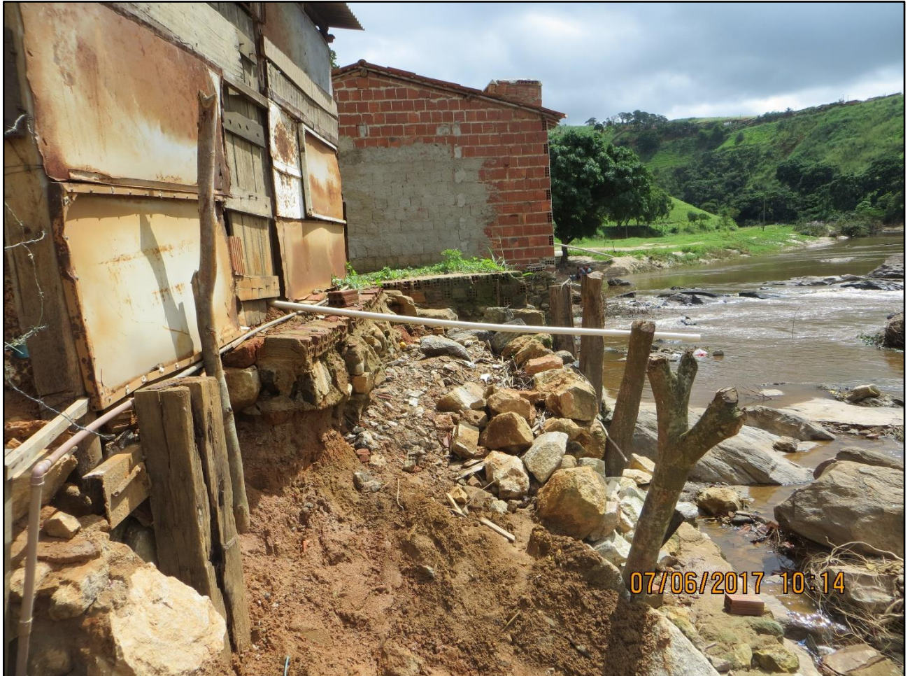
Foto 01: Solapamento das margens do Rio Pirangi, provocado pelas inundações de 05/2017, erodindo a base das casas ribeirinhas de Maraiial-PE.
