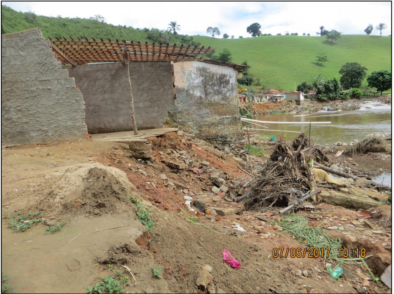
Foto 02: Solapamento das margens do Rio Pirangi, provocado pelas inundações de 05/2017, erodindo a base das casas ribeirinhas de Maraiá-PE. Observa-se a destruição das moradias, as quais haviam sido construídas no leito de inundação do rio (local impróprio e proibido pela legislação ambiental).
