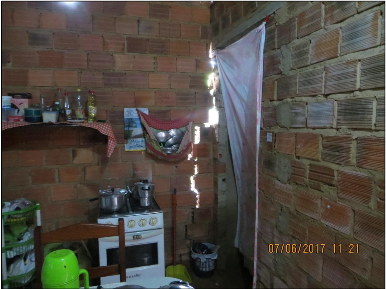
Foto 12: Observa-se nas paredes das casas rachaduras provocadas pela movimentação do solo, devido ao rompimento do aterro inconsolidado, sobre o qual as moradias da Comunidade do Cuscuz foram construídas.
