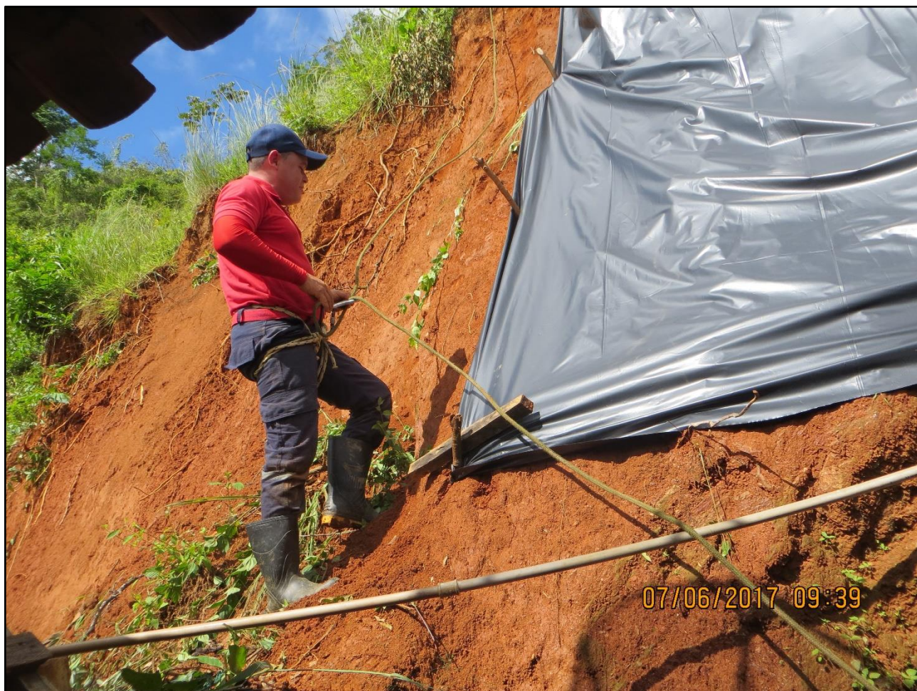
Foto 07: Lonas plásticas em processo de colocação pela Defesa Civil Municipal em parceria com os Bombeiros Militares da CODECIPE-Casa Militar do Estado de Pernambuco e Bombeiros Civis, para uso como proteção provisória.
