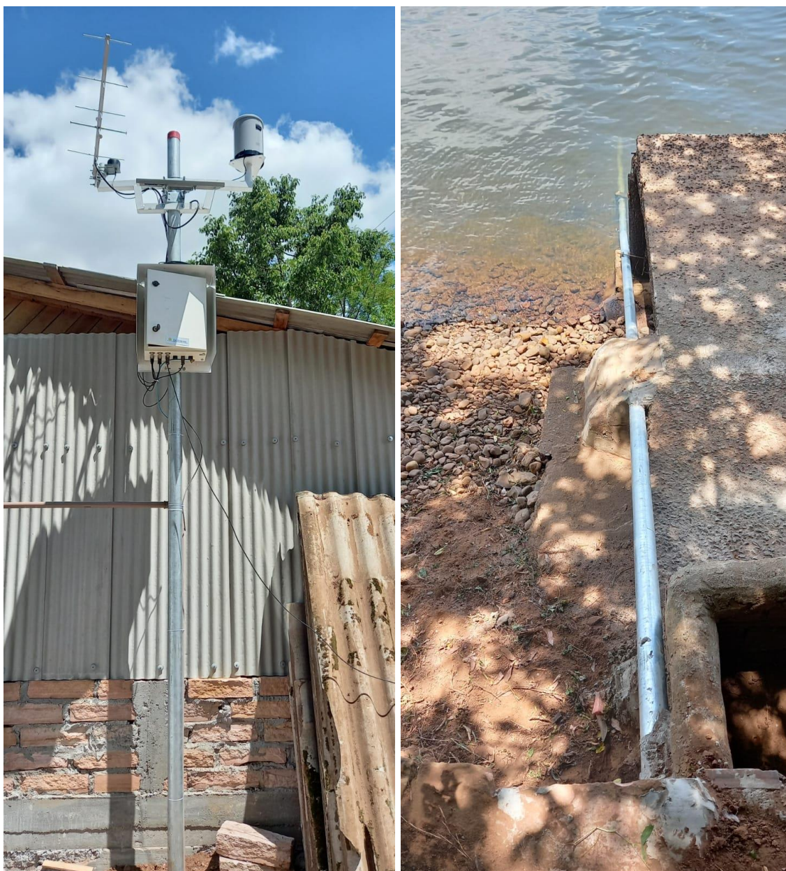
Figura 35. Instalação de PCD com transmissão GOES na estação Porto Mariante, dezembro de 2021.
