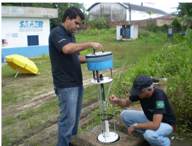
Figura 2. Instalação de medidor de nível automático tipo borbulhamento. Poço cedido do extinto SAAEB. COSANPA para a RIMAS-BE. Poço Belém-Mosqueiro-SAAEB-5ª Rua. SIAGAS: 1500005085. 24/03/ 2011.
