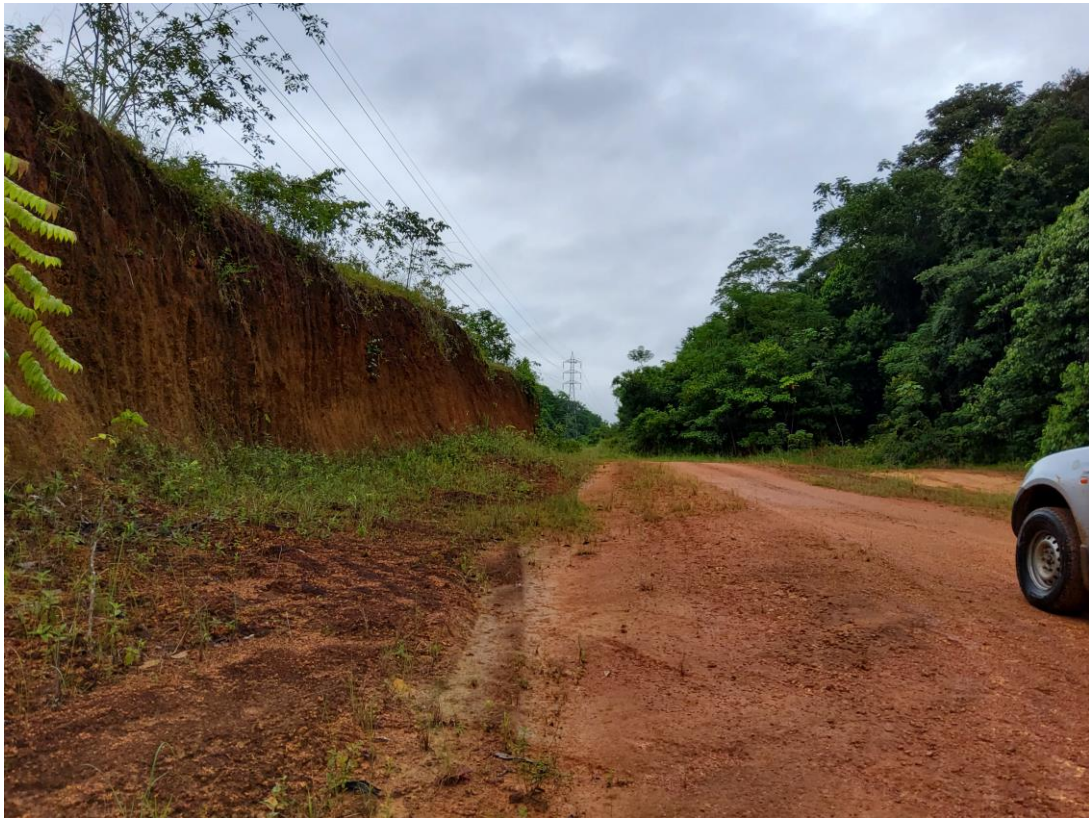
Figura 13 – Exemplo de tabuleiro de baixa amplitude sustentado por costa laterítica. Foto: Autores.
