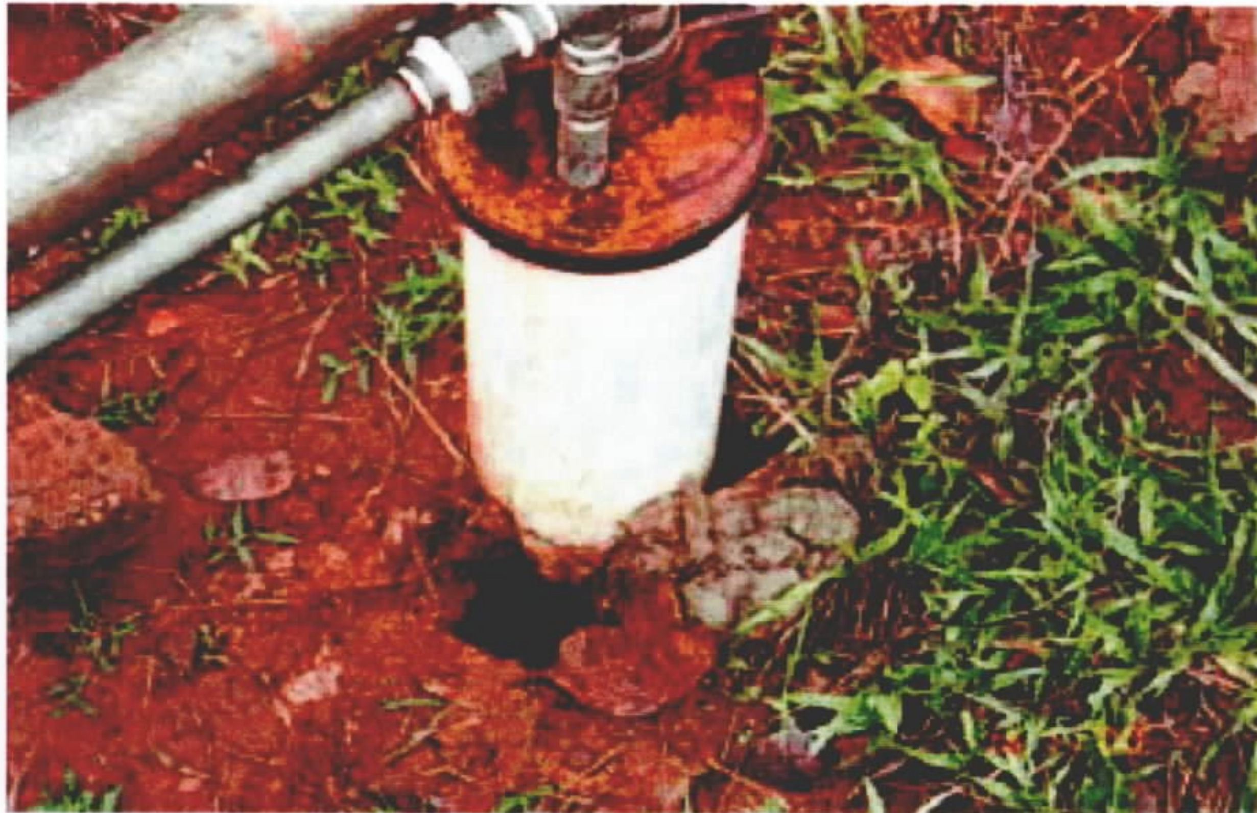
Foto 7 - Poço tubular com risco potencial de contaminação elevado. Em virtude da ausência de cimentação do espaço anelar e da laje de proteção sanitária ocorreu o solapamento da parede lateral ao revestimento. Esta situação facilita a infiltração de água superficial e contaminantes.
