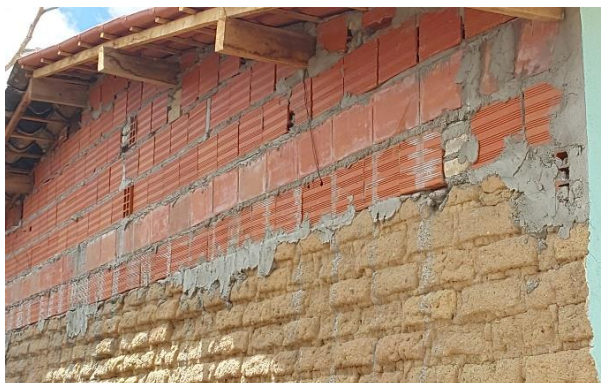
Figura 8 – Imagem evidenciando o padrão construtivo misto entre adobe e tijolos, o que aumenta a vulnerabilidade dos imóveis. Fonte: Anselmo Pedrazzi.
