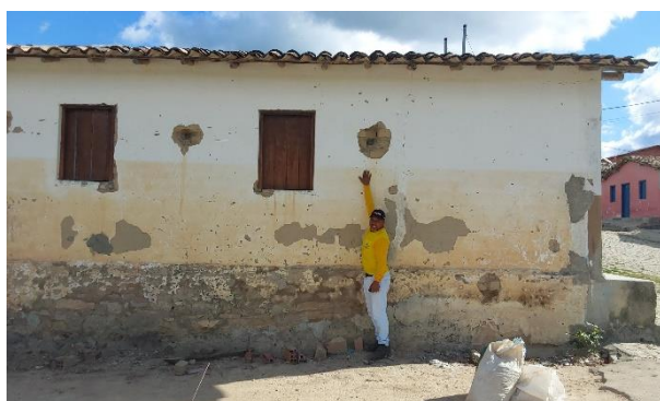
Figura 20 – Imagem exibindo a marca que as águas deixaram em imóvel na rua Santos Dumont. Fonte: Anselmo Pedrazzi.
