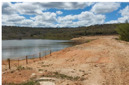
Figura 19 – Imagem recente da Barragem Iracema, já reforçada após o desastre. Fonte: Anselmo Pedrazzi.
