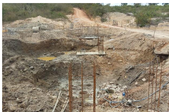
Figura 21 – Imagem do local onde a ponte sobre o córrego Taperas que ligava a rua Santos Dumont a rua do Cemitério, foi destruída pelo desastre. Atualmente se encontra em obras para a construção de uma nova ponte. Fonte: Anselmo Pedrazzi.
