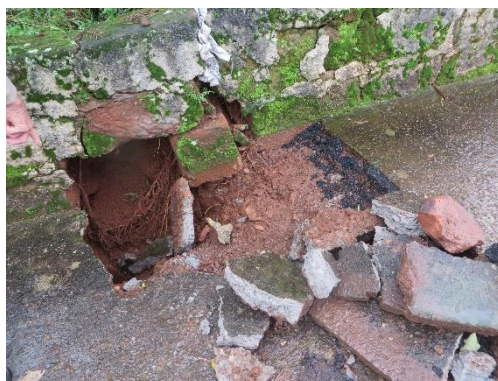
Figura 11 – Feição erosiva entre o pátio de moradia e início de uma das rachaduras visualizadas no asfalto.
