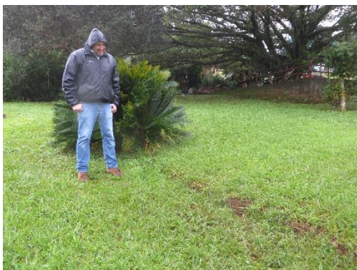
Figura 12 – Pequeno degrau de abatimento no terreno da moradia, mostrando continuidade das rachuras visualizadas na rua Padre Afonso Weiler.
