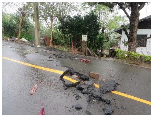
Figura 13 – Rachaduras e surgimento de material em outro ponto no asfalto na rua Padre Afonso Weiler.
