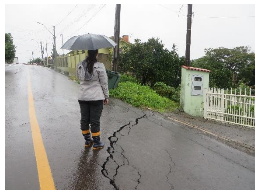
Figura 5 – Rachaduras e trincas no asfalto da rua Bento Gonçalves.
