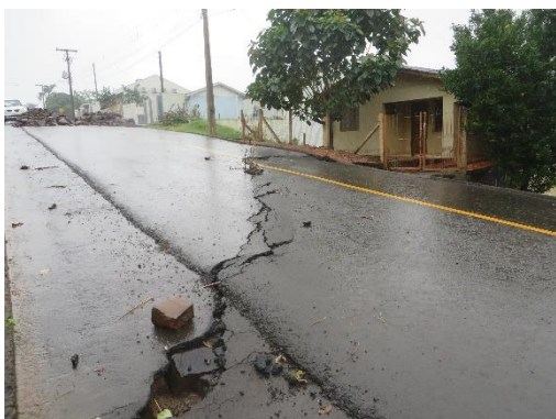
Figura 10 – Trincas e rachaduras no asfalto na rua Padre Afonso Weiler.
