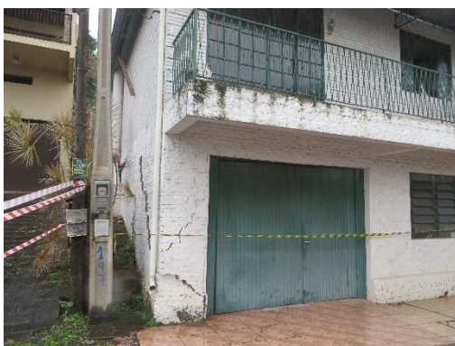
Figura 4 – Moradia com rachaduras na rua Bento Gonçalves.
