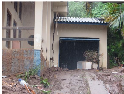
Figura 9 – Moradia com rachadura na rua General Neto, importante ressaltar que esta moradia também sofreu com a inundação do Rio Taquari.
