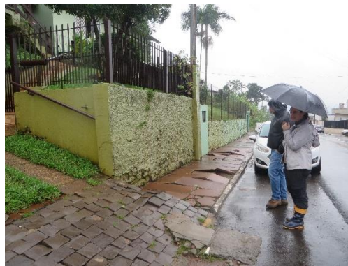
Figura 7 – Calçada e muro de moradia com rachaduras e alteradas após as chuvas de maio.
