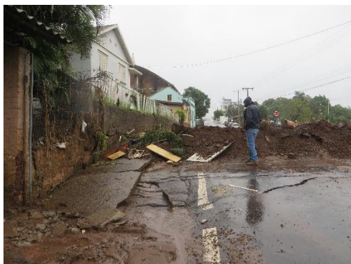
Figura 8 – Degrau de abatimento e rachaduras no asfalto na rua General Neto.
