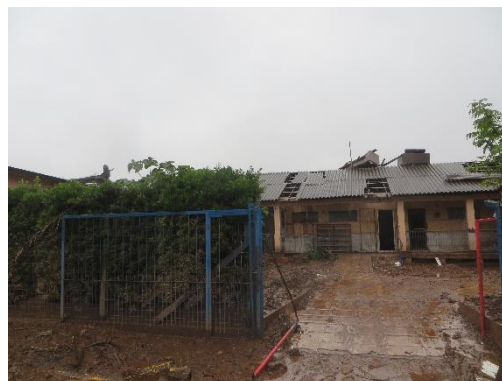
Figura 15 – Moradia e escola com sofás e árvores de médio porte em cima dos telhados atingidas nas imediações da rua Rubens Feldens na inundação brusca de abril/maio.
