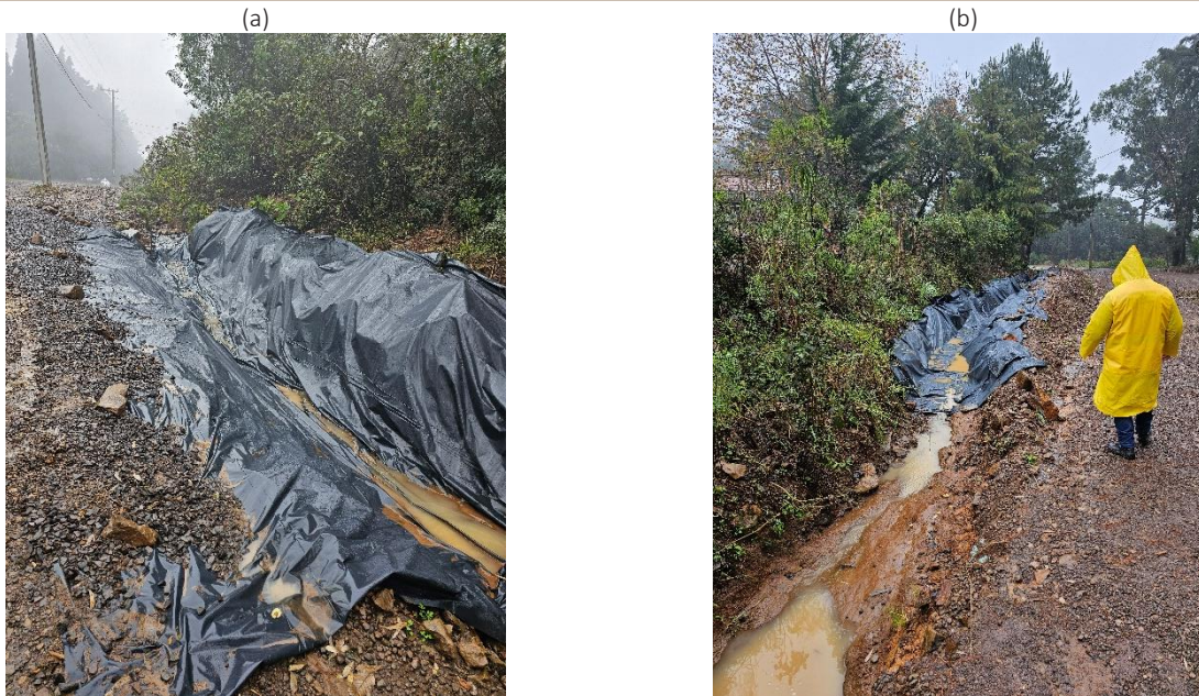
Figura 7 – Ravinamento adjacente ao eixo da estrada local: (a) e (b) lonas utilizadas para evitar a infiltração de água no solo.
