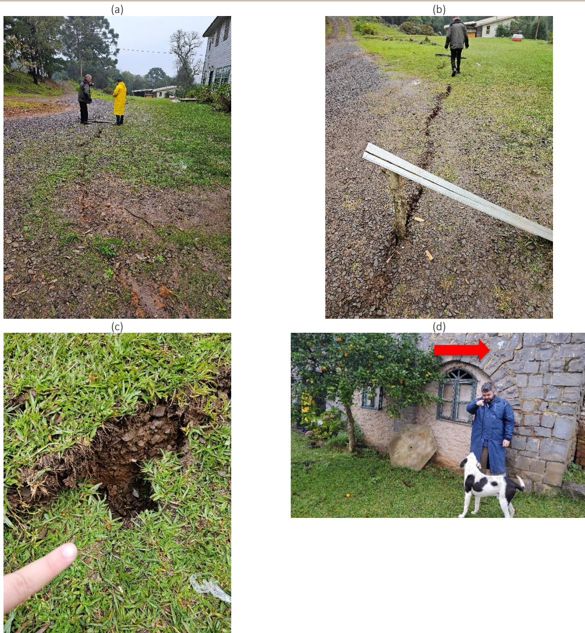
Figura 5 – Trincas de cisalhamento no solo observadas na região da barragem do Salto: (a) e (b) trinca com abertura centimétrica e extensão de vários metros; (c) natureza do material: aterro e (d) trinca de cisalhamento na estrutura da edificação.
