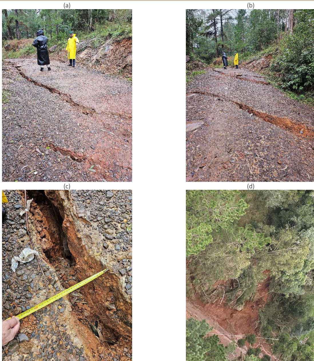
Figura 6 – Condições geotécnicas observadas em acesso abaixo do hotel: (a) e (b) trincas de cisalhamento observadas no pavimento do acesso, com abatimento de terreno de alguns centímetros chegando a decímetros; (c) abertura de trinca de cisalhamento em torno de 20 cm e (d) deslizamento planar raso em corte de estrada.
