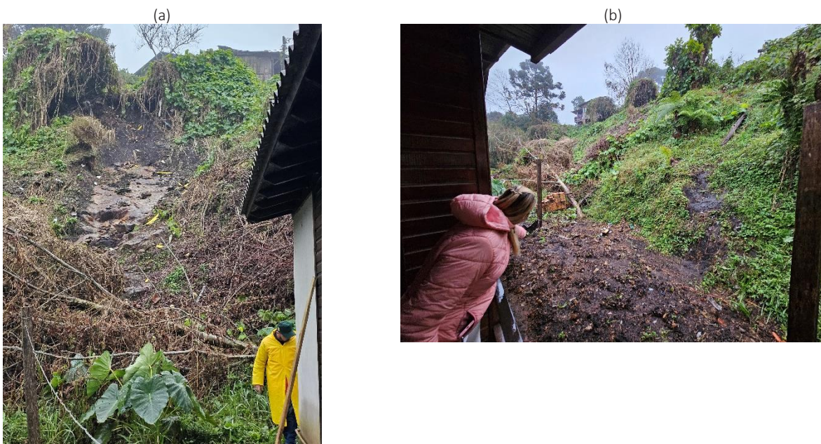
Figura 10 – Deslizamento vistoriado na rua Dr. Ângelo Aranázio: (a) deslizamento planar raso em face de encosta de alta declividade e (b) encosta de alta declividade bastante saturada em resposta as intensas chuvas e fluxo de água proveniente da rua acima.
