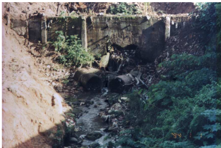
Figura 1: Esgoto a céu aberto na Av. Djalma Batista.
