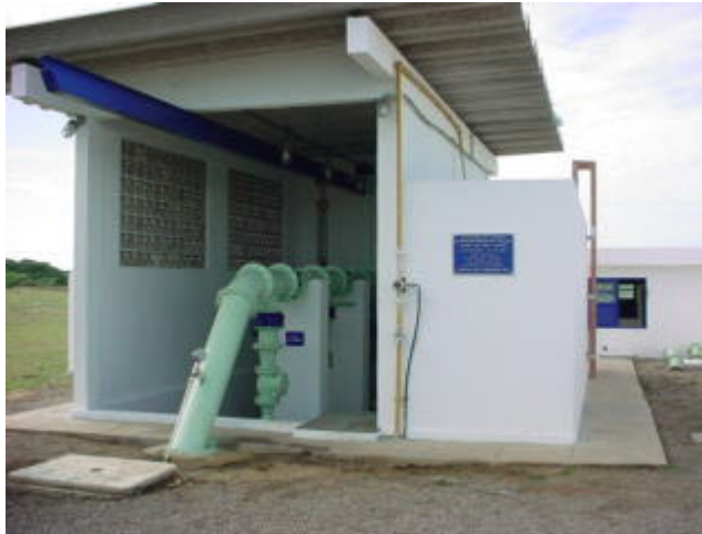
Fig. 15. Poço tubular sob responsabilidade da Águas do Paraíba, em Boa Vista do Farol. Fonte: DRM.
