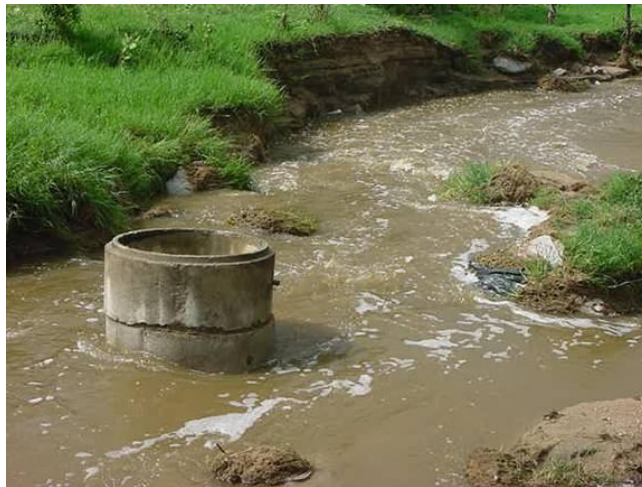
Figura 6 – Erosão verificada na Barragem Cafundó I no distrito de Mutuca - PE.
