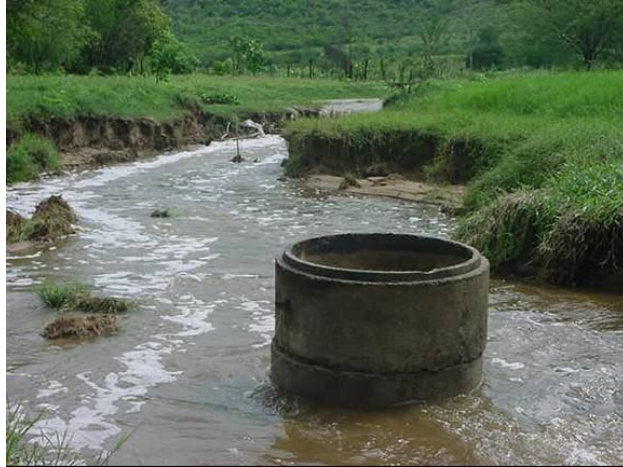
Figura 5 - Voçoroca causada pela força das águas na Barragem Cafundó I no distrito de Mutuca – PE
