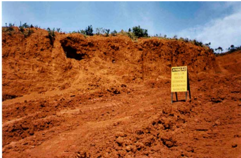
FOTO 26 - Área de extração de bauxita com aviso da presença de cavernas.
