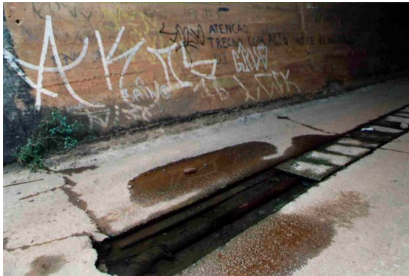
FOTO 6 - Captação no sistema de drenagem do Túnel Taquaril, Nova Lima (ponto 773).
