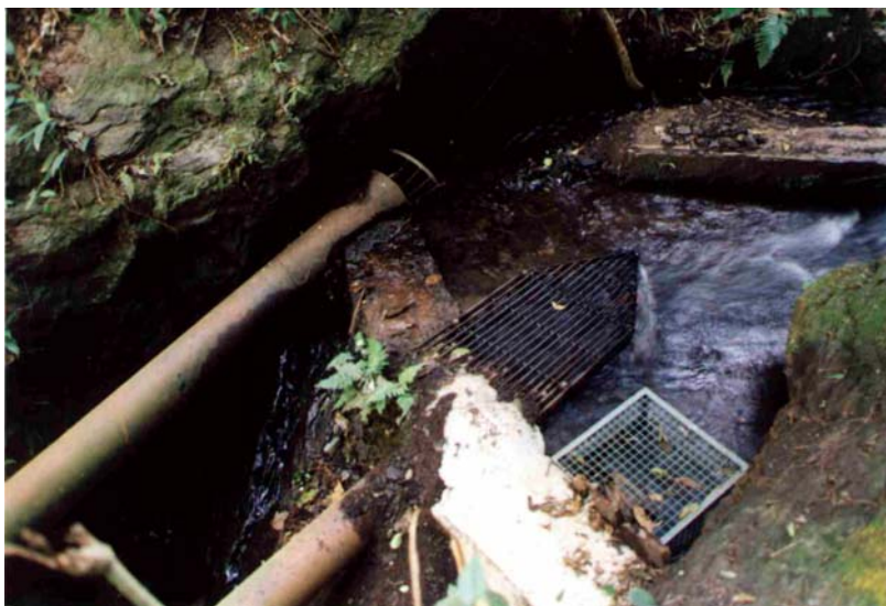
FOTO 12 - Captação Mãe d'Água na região do Retiro do Chalé, Brumadinho (ponto 250).
