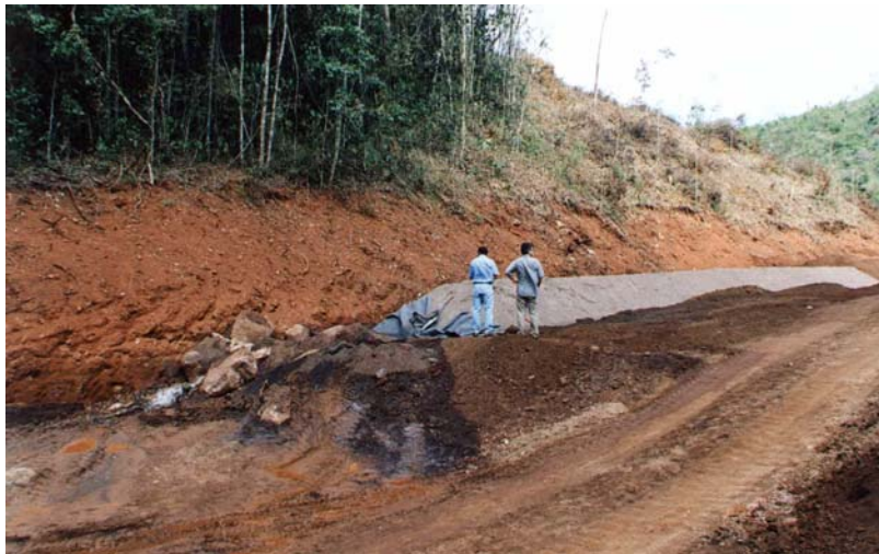
FOTO 22 - Instalação de manta drenante no aterro de estéril na Mina do Tamanduá.
