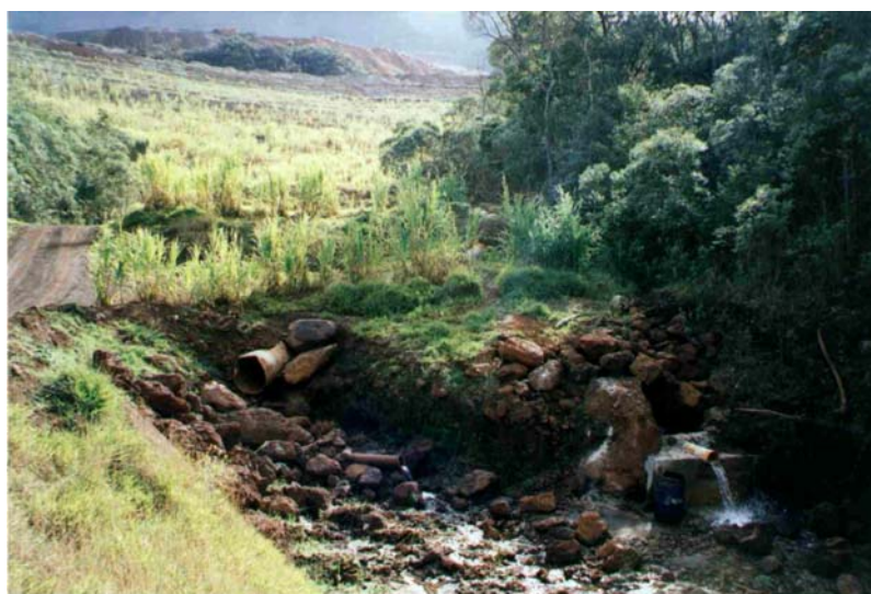
FOTO 19 - Dreno de fundo do aterro de estéril na Mina Capanema (ponto 1.104).
