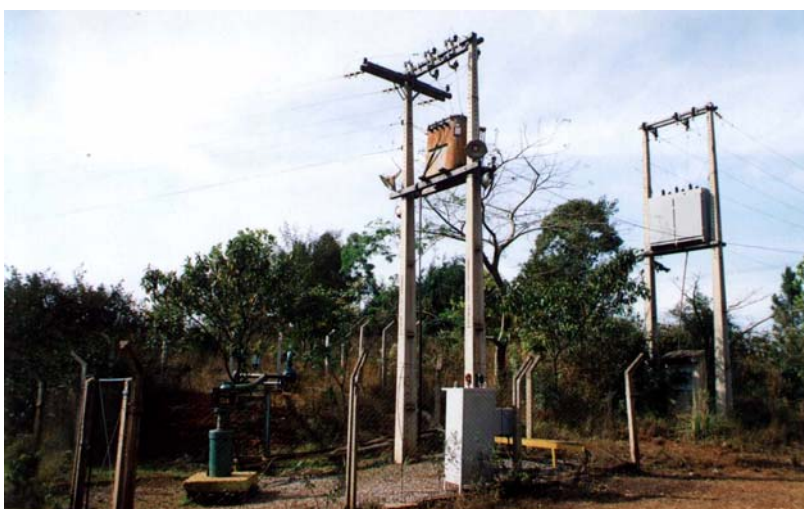
FOTO14 - Instalações do poço P-04 no condomínio Morro do Chapéu (ponto 468).
