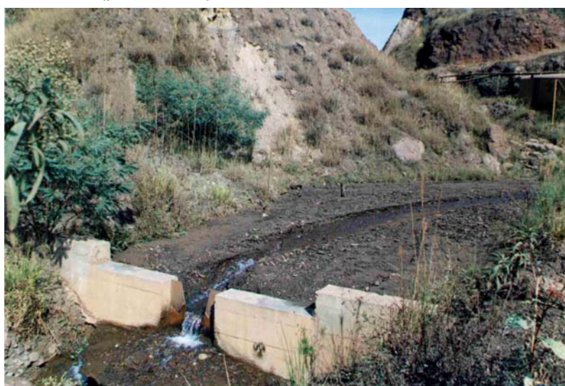
FOTO 20 - Assoreamento em nascente na Mina do Tamanduá, Nova Lima.
