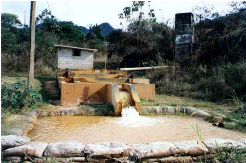
FOTO 25 - Tratamento de drenagem ácida na Mina do Faria, Honório Bicalho, Nova Lima (ponto 815).
