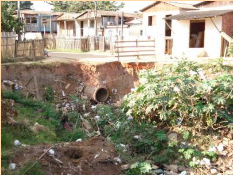
Fotografia 19: Voçoroca no Bairro Cidade Nova, margem do rio Acre. O lançamento das águas pluviais sobre terreno arenoso desencadeou o fenômeno erosivo. Detalhe das péssimas condições de saneamento do local.
