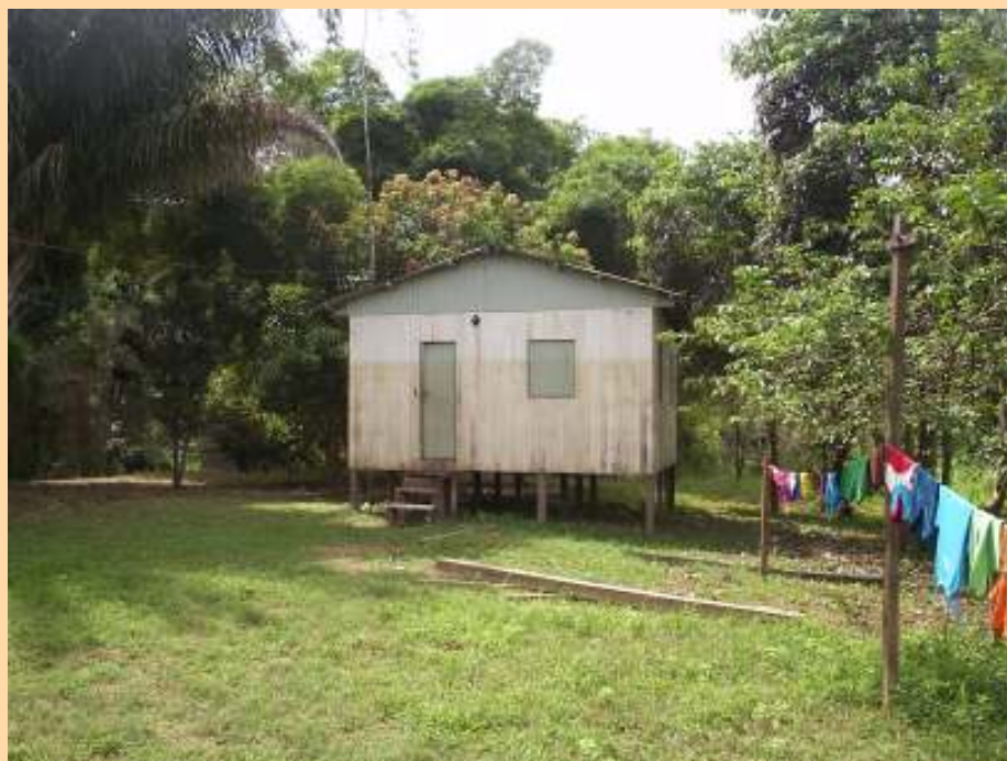
Fotografia 20: Moradia em área sujeita às enchentes, na parede está marcado o nível da água atingido em 2006. Igarapé São Francisco, bairro Adalberto Aragão.
