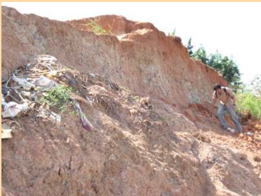
Fotografia 14: Deslizamento no topo da encosta mais elevada do bairro Papoco. Argila mosqueada de cor vermelha amarelada. Detalhe da disposição de lixo irregular na encosta
