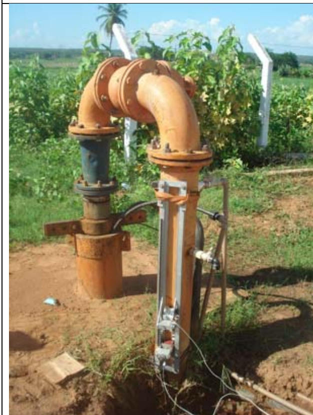
Detalhe do sensor do medidor de vazão ultrassônico
