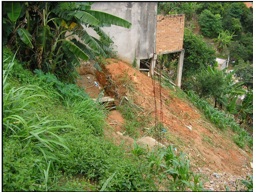
Figura 28 – Casa em área de risco de ocorrência de processos erosivos e movimento de massa.
