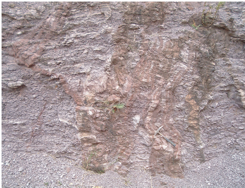
Foto 2: Zona de cimentação pronunciada direto sobre os siltitos. Notar ramificação rumo ao topo.
