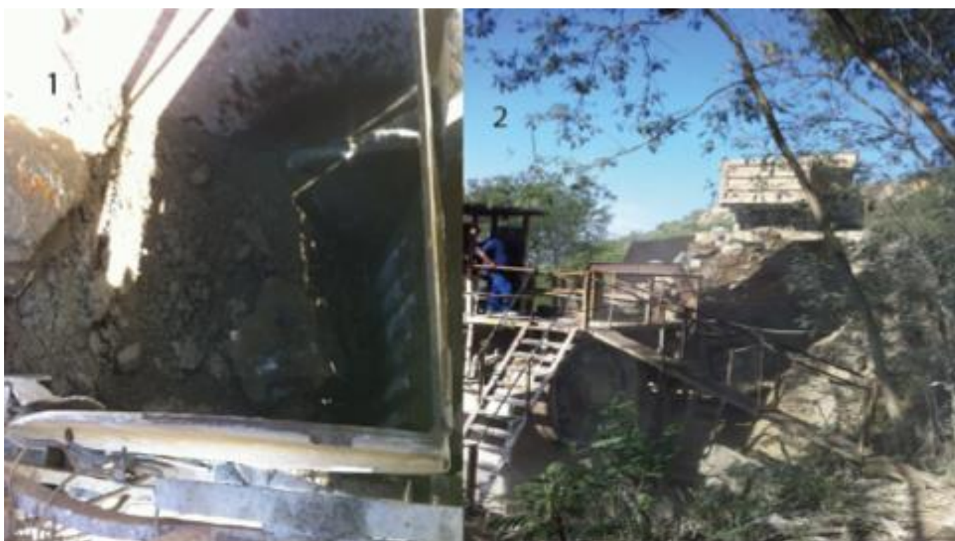
Figura 12 - Britador de mandíbula primário da Pedreira Cispel
