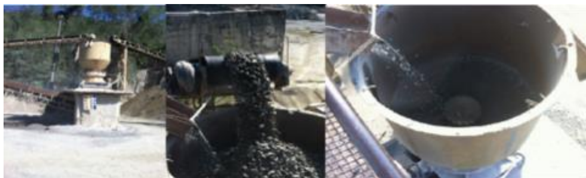
Figura 13 - Britadores cônicos secundário e terciário da Pedreira Cispel
