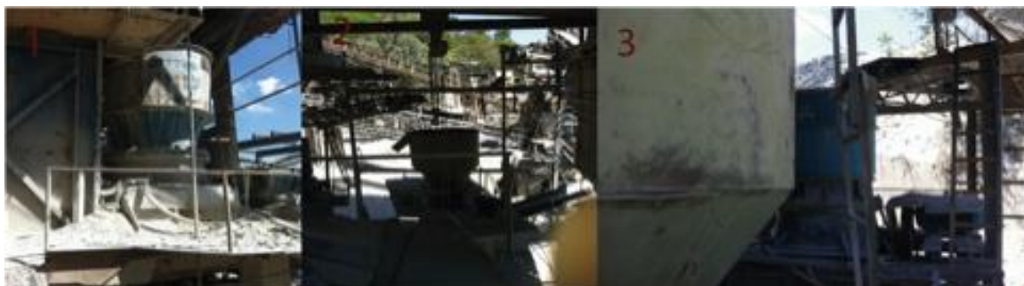
Figura 20 - Britadores cônicos. (1) e (2) Britadores secundário, (3) britador terciário da pedra Vigné durante a visita deste estudo
