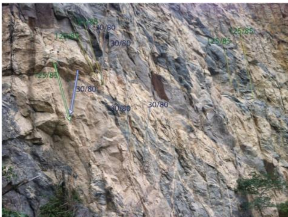
Figura 22 - Fraturas encontradas na pedreira Lafarge durante a visita deste estudo
