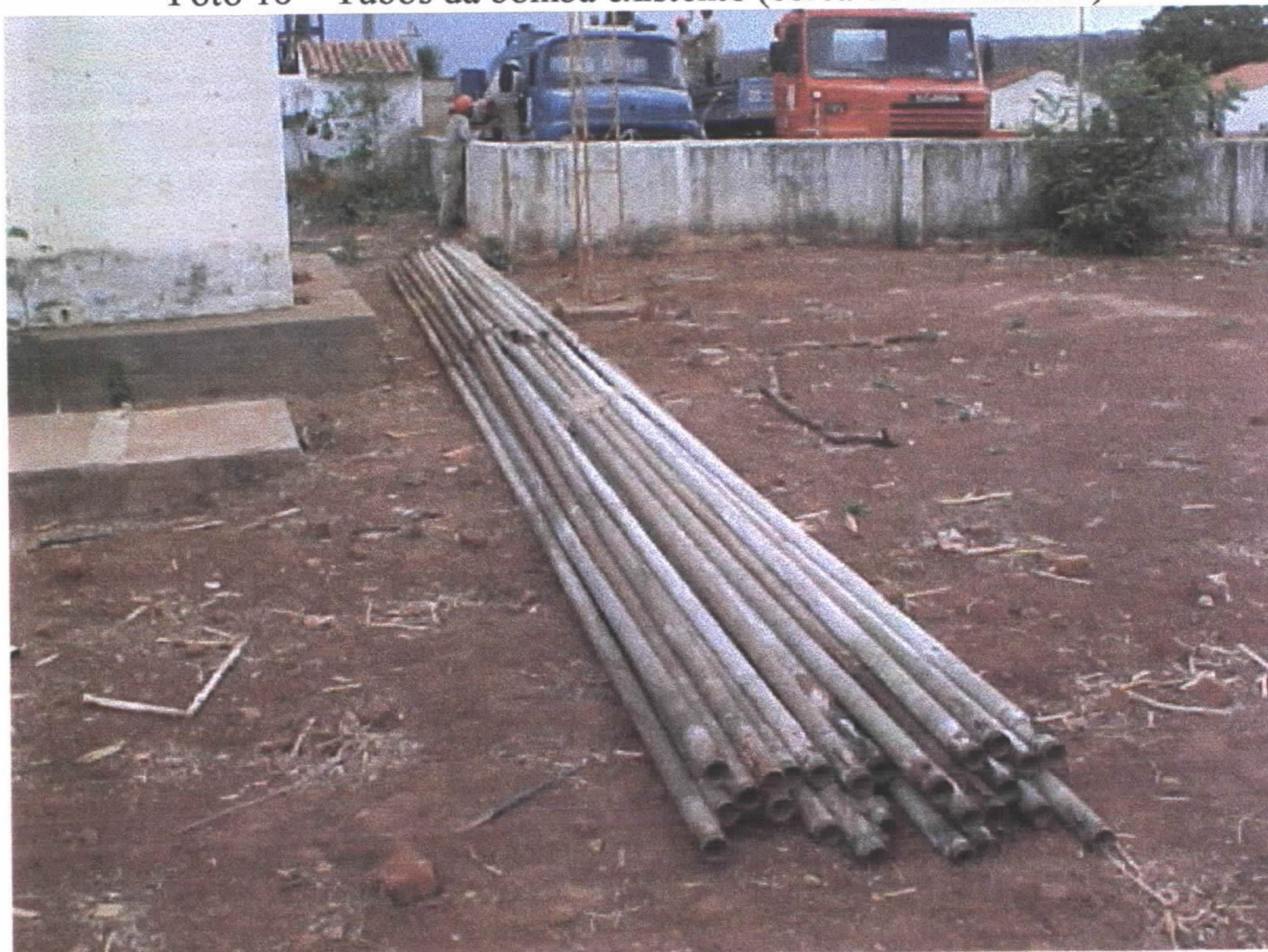
Foto 18 – Tubos da bomba existente (cerca de 340 metros)
