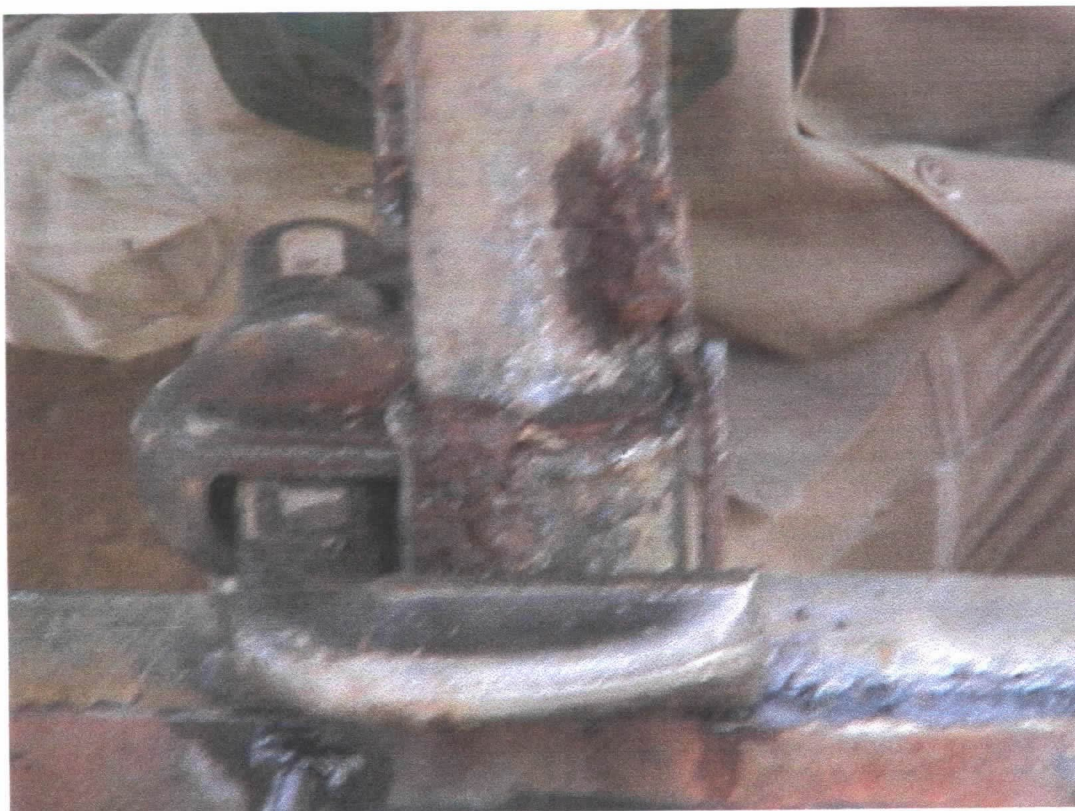
Foto 17 – Retirada da bomba existente (detalhe da má conservação dos tubos)
