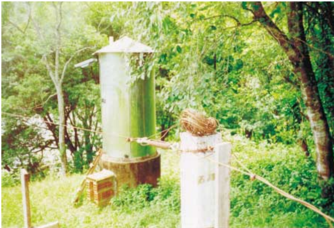
Estação pluvio-fluviométrica de Passo do Socorro, Rio Grande do Sul, conjugada com medições de qualidade de água e com sistema telemétrico
