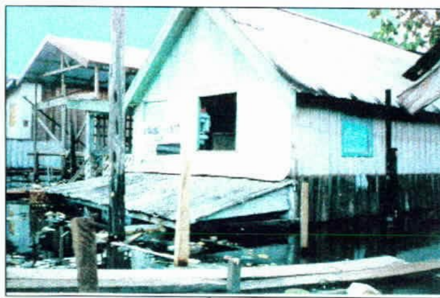
Foto 12 - (Água no 2º Piso) Cota 28.76 m - 09/06/93
