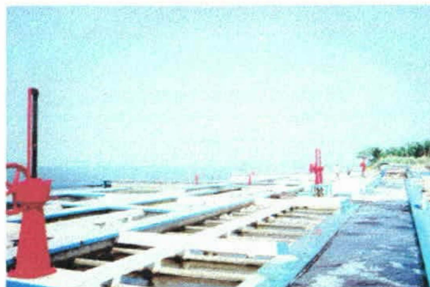
Foto 8 - Estação de Tratamento d' Água Cota 15.87 m - 09/10/95
