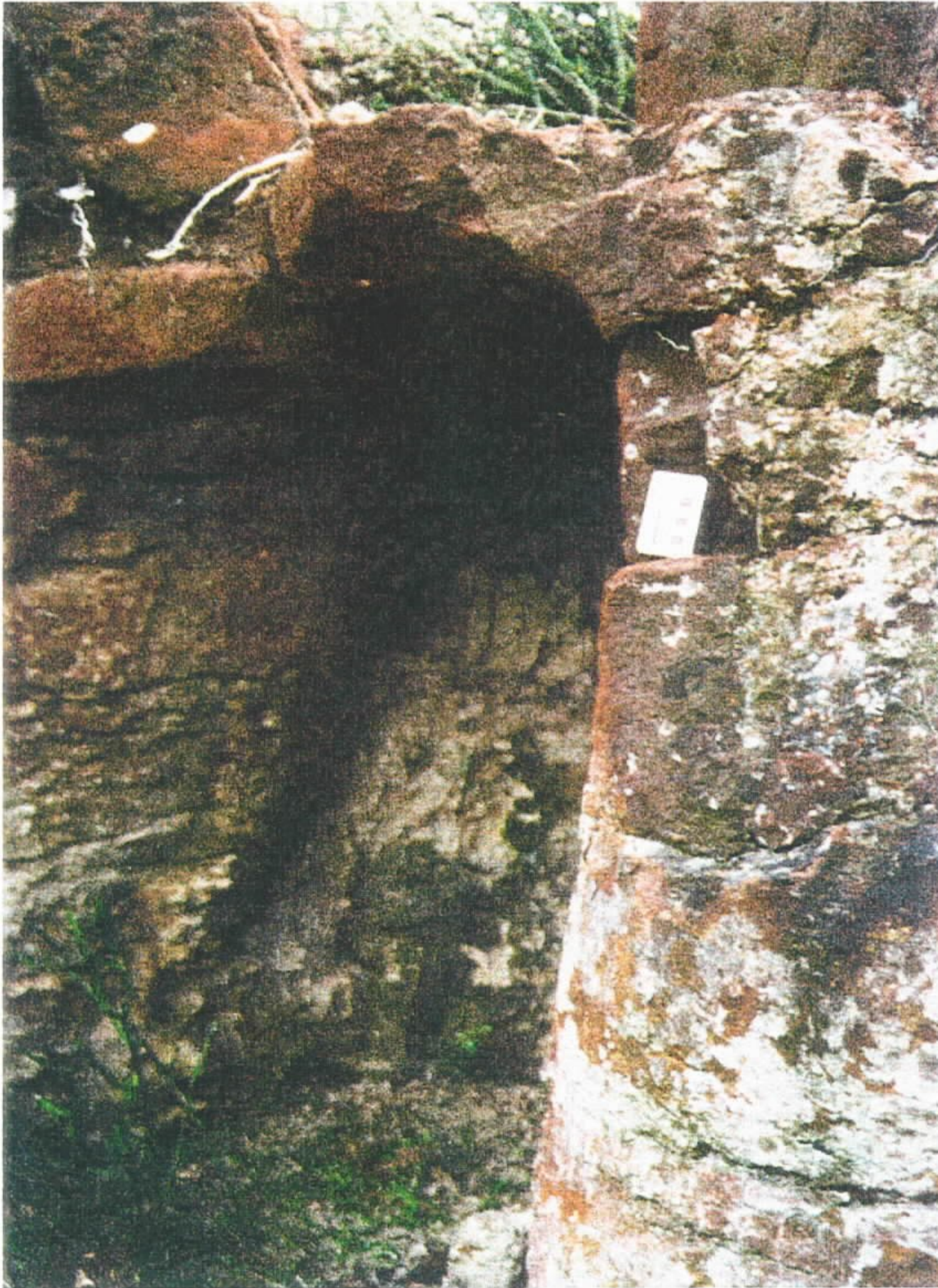
Foto 06 - Detalhe da estrutura em arco do arenito ferruginizado que constitui o teto da gruta. Inicialmente há material muito ferruginizado, com espessura de até 8cm. Segue-se o mesmo arenito de textura concrecionária das colunas. Acima dele, as lentes de arenito ferruginizado, vermelho.
