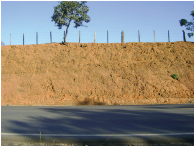
Figura 4.37 - Talude de corte em solo com boa estabilidade e baixo potencial erosivo (município de Córrego Fundo).
