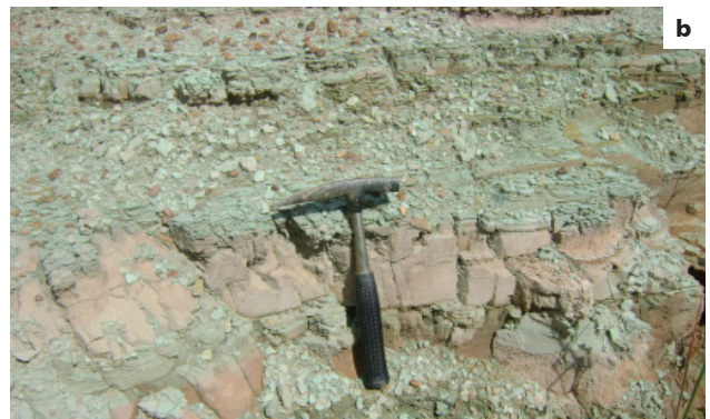
Figura 4.30 - (a) erosão em sulco em argilito verde, induzida pela exposição em talude de corte de solos contendo argilominerais expansivos; (b) detalhe do afloramento mostrando o empastilhamento que se forma com a desagregação da rocha (município de Córrego Danta).
