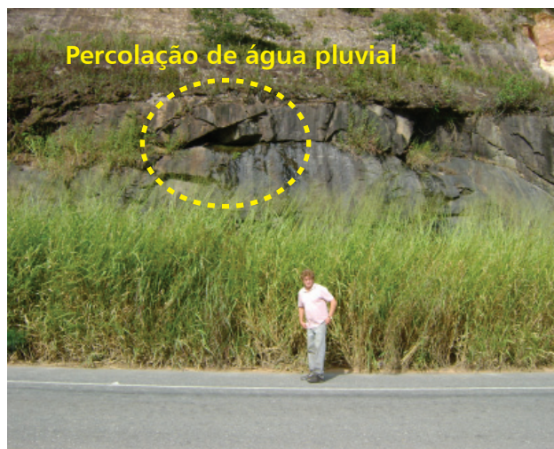
Figura 4.90 - Talude de corte de estrada em granito com muitas fraturas e fendas, o que o torna bastante percolativo, favorecendo rápida infiltração tanto de água pluvial quanto de contaminantes (município de Abre Campo).
