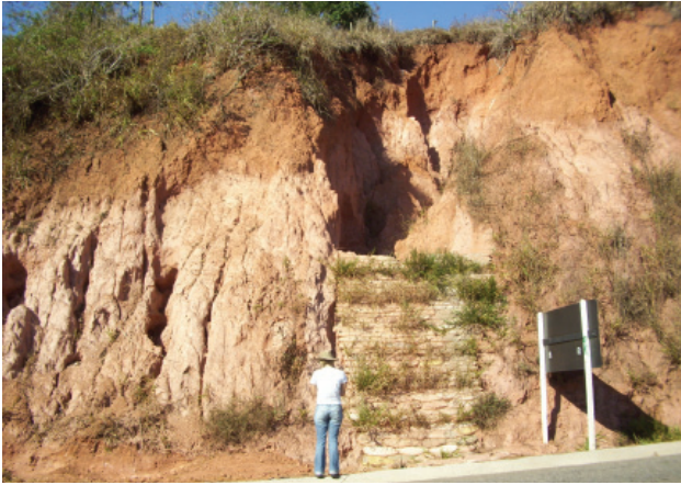
Figura 4.36 - Exemplo de talude de corte em manto de alteração derivado da unidade geológico-ambiental 23, com elevada suscetibilidade à erosão – sulcos e ravinas. Muro de contenção erguido como tentativa de conter o avanço do processo erosivo (município de Belo Oriente).
