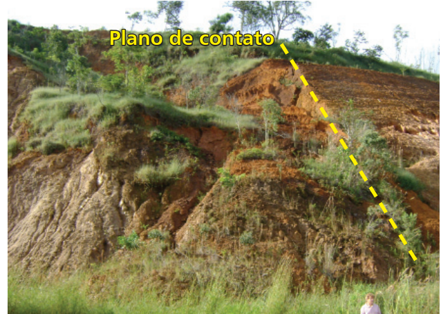
Figura 4.52 - Movimento de massa em talude de corte formado a partir do plano de contato entre camadas litológicas de comportamento geotécnico diferente (município de São Domingos do Prata).
