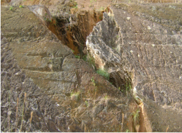
Figura 4.50 - Talude em corte de estrada em seqüências sedimentares com processo erosivo mais evoluído na camada xistosa, devido à diferença geotécnica entre os litotipos (município de São Domingos do Prata).
