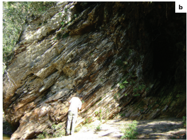
Figura 4.63 - Taludes de corte em maciços intensamente deformados, com alto potencial para ocorrência de deslocamento e quedas de blocos - município de Nova Era. (a) maciço em litotipo da unidade geológico-ambiental 37; (b) maciço em litotipo da unidade geológico-ambiental 38.
