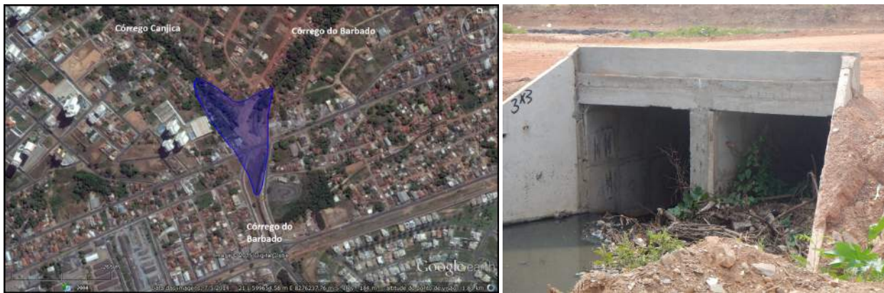
Figura 8. Setorização em imagem de satélite e bueiro celular obstruído
