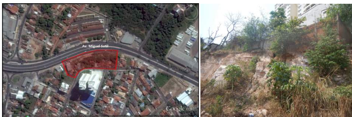
Figura 1. Setorização em imagem de satélite e avanço do talude
