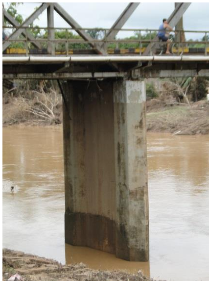
Figura 57. Ponte sobre o rio Acre, em Brasileia/Epitaciolândia, com nível das águas rebaixado, após inundação que atingiu o leito da ponte.
