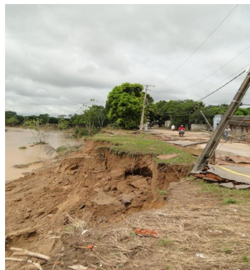
Figura 20. Avanço da frente erosiva. Rua dos Catraieiros, pós Rua Um.
