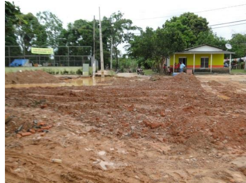
Figura 18. Vala recuperada pós-inundação. Rua Olegário França x Rua Catraieiros.
