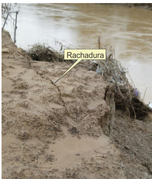
Figura 25. Rachadura na rua Um. Bairro Leonardo Barbosa.
