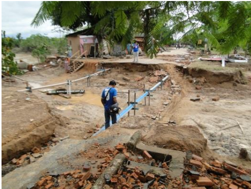
Figura 17. Vista parcial da vala, pós-inundação. Rua dos Catraieiros.
