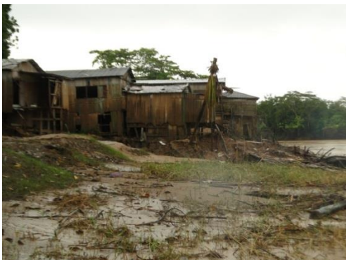
Figura 32. Rua Major Salinas. Março de 2015. Instabilidade de construções.
