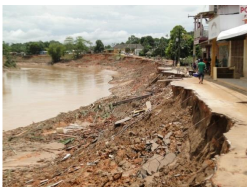
Figura 28. Solapamento de taludes fluviais. Rua Rolando Moreira.
