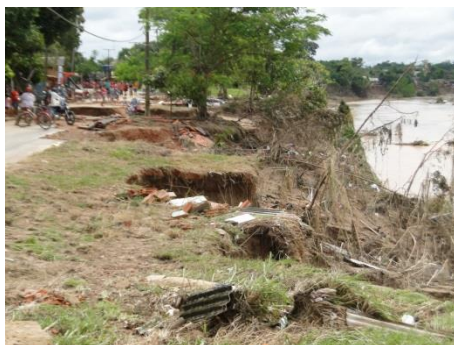
Figura 19. Barrancos erodidos. Rua dos Catraieiros.
