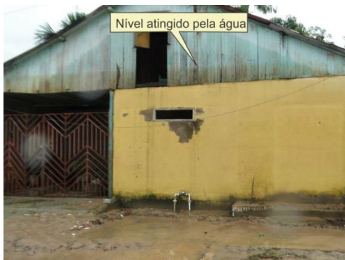
Figura 37. Imóvel inundado pelo rio Acre, indicando nível d'água. Rua Major Salinas.
