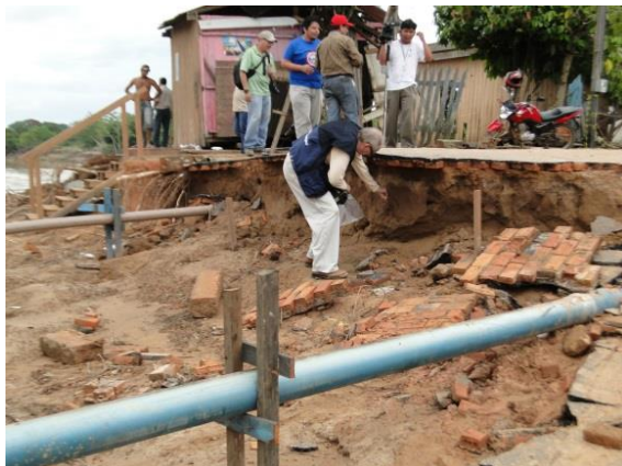
Figura 46. Coleta de sedimento aluvionar na vala erodida.
