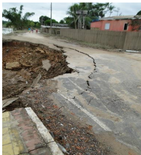
Figura 26. Rachadura na Av. Mal. Rondon, junto a Rua Major Salinas, marginal ao rio Acre. Brasileira.
