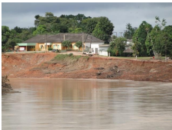
Figura 31. Unidade hospitalar de Brasileia, junto a barranco erodido parcialmente.
