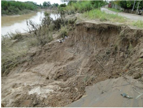
Figura 14. Taludes fluviais expostos à ação intempérica. Queda parcial do talude durante a visita.
