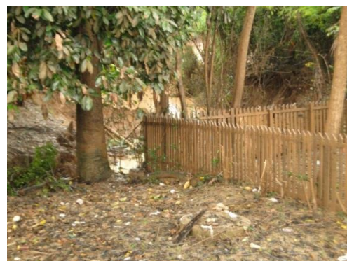
Figura 39. Fundos da casa de Chico Mendes, em risco pela instabilidade de talude.
