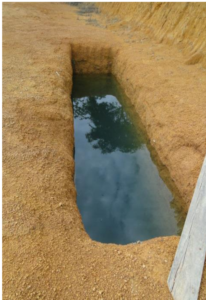
Figura 33. Trincheira repleta de água no fundo da escavação.
