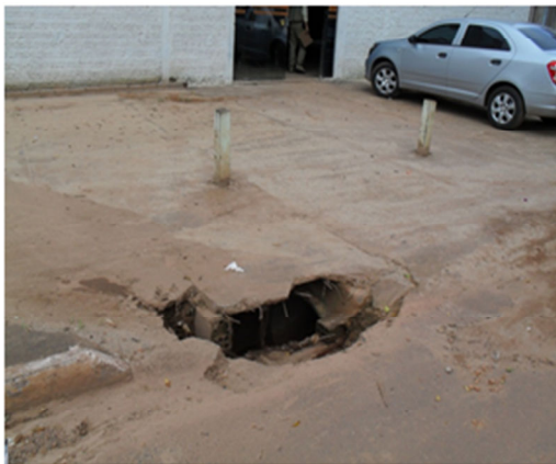
Danos causados devido ao nível da água
