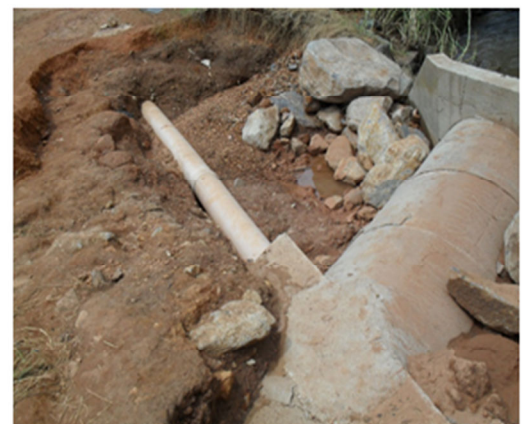
Rede de esgoto danificada
