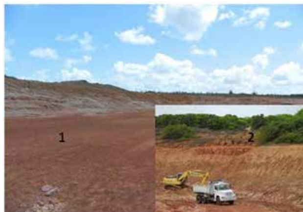
Figura 8.5 – (1) Área de produção da JC de Oliveira Mineração, localidade de Jenipabu no município de Extremoz. (2) Desmonte e carregamento com escavadeira hidráulica e transporte por caminhões rodoviários (foto 2, de Rodrigo Sena, blog AFAUNA).
