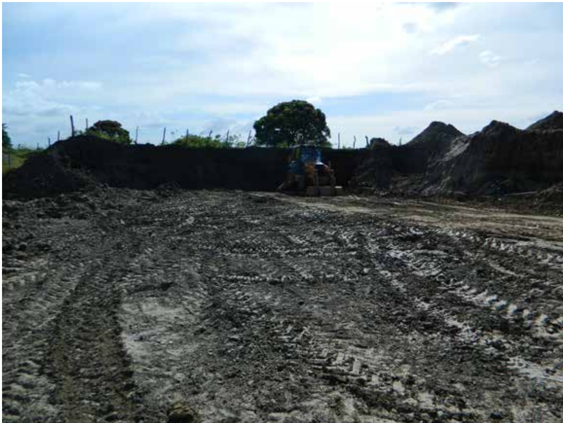
Foto 4.6 – Extração de argila em terrenos aluvionares, localizada no Município de São Gonçalo da Amarante.
