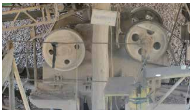
Figura 8.5 – Rebritadores modelo 90.26 FAÇO, do material proveniente da peneira vibratória ( oversize ).
