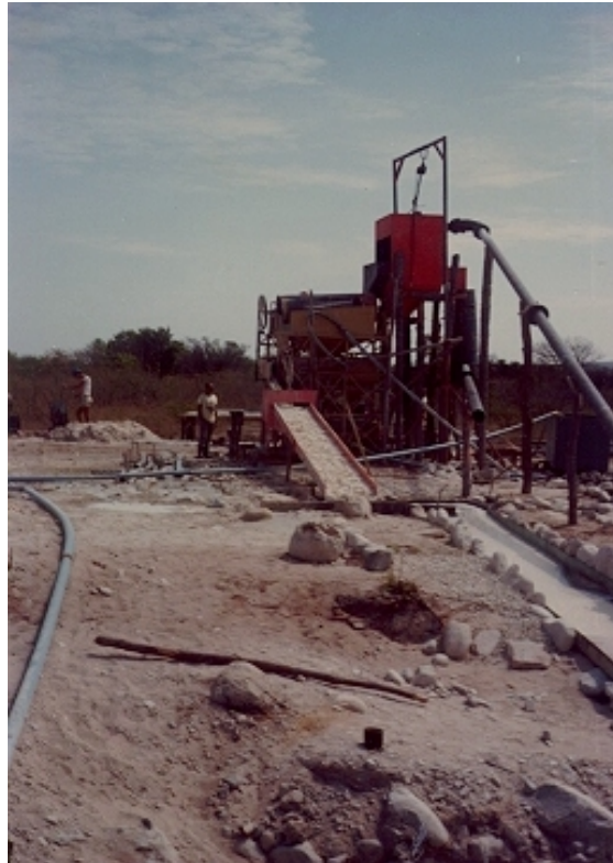
Foto 15 - Sistema OUROTEC em operação mostrando, na entrada, cone desaguador, objetivando maior rendimento nas operações de beneficiamento do cascalho. Na saída, bica concentradora.
