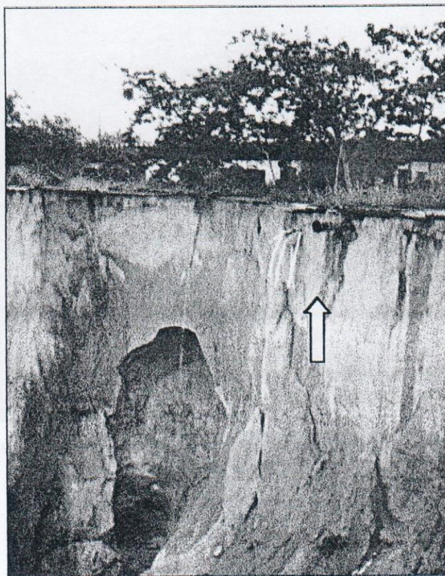
Figura 13 – Sistema de escoamento das águas pluviais que detonou o processo de boçorocamento observado no terreno da CIBRAZEM (Ponto 40 do Mapa de Distribuição dos Processos Erosivos – Anexo 5).
