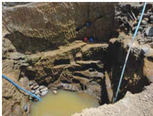
Foto 5.21 – Garimpo da Roça – cava (4 m de comprimento x 4 m de largura x 7,5 m de profundidade) que está sendo aberta para extração de opala.
