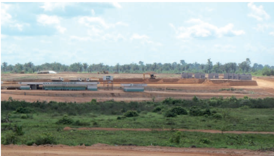
Figura 3.24 - Paisagem mostrando uso de saibro em obra de construção de residências do Projeto “Minha Casa Minha Vida”, do Governo Federal, em Itupiranga.
