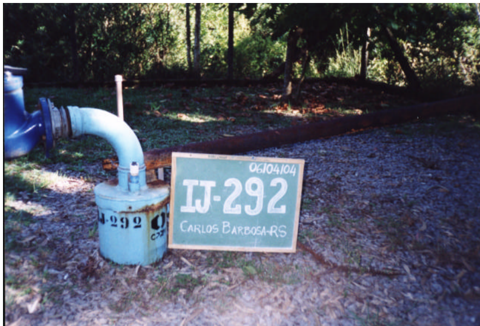
Figura 2 – Registro fotográfico do poço com placa de identificação
