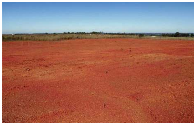
Foto 7.17 – Lavra de cascalho com o piso já nivelado, aguardando o plantio de gramíneas, município de Anápolis.
